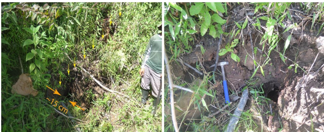
Figura 26. Grietas de tracción en el terreno con abertura de ~15 cm y saltos que van de 30 a 40 cm de desnivel, situados a pocos metros de los bloques propensos a caída.
