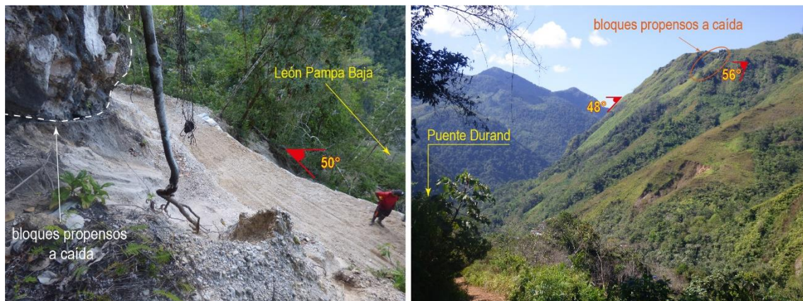
Figura 12. Pendientes promedio del terreno en los sectores León Pampa y Puente Durand. En ambos sectores se observan los bloques propensos a caída, dispuestos en pendientes fuertes y escarpados a abruptas.
