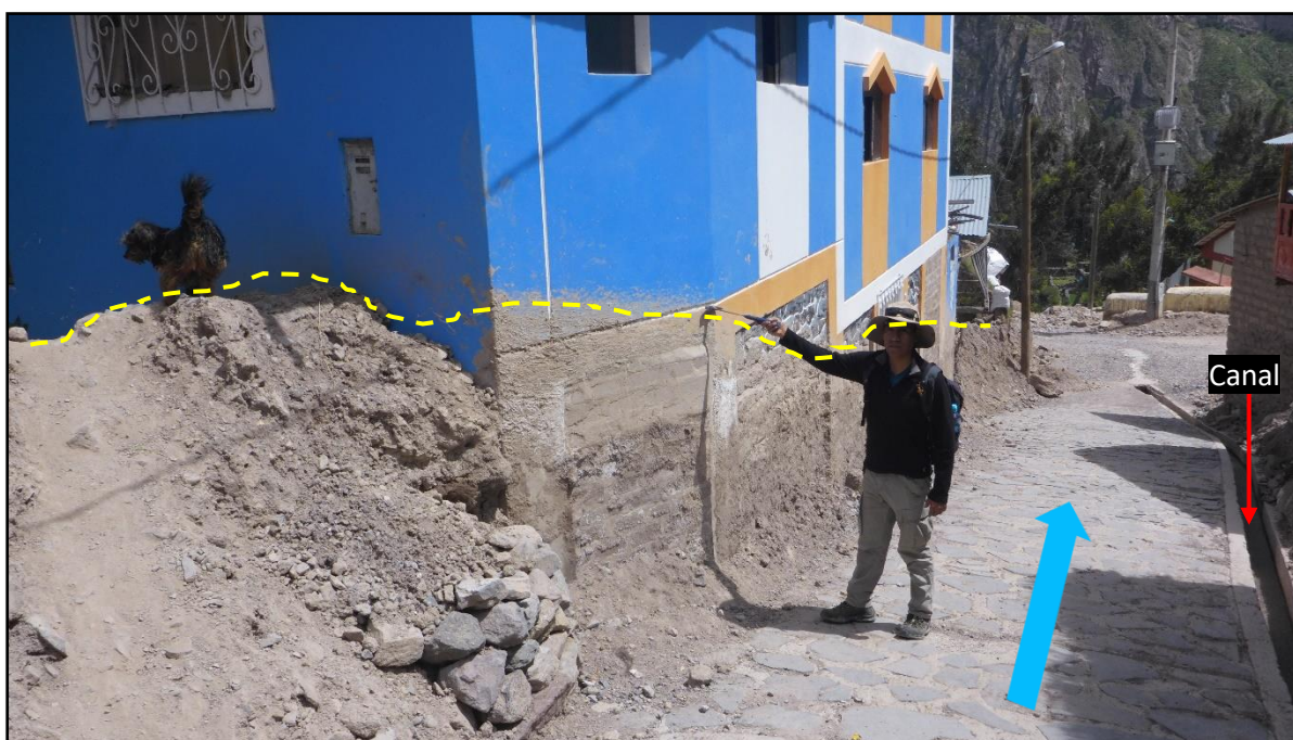
Figura 9. Marcas del paso del flujo de detritos del 19/02/2024 en las paredes de las viviendas del Centro poblado Suni.
