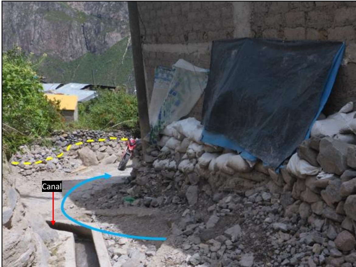
Figura 10. Las aguas provenientes de la quebrada Humatimpo son evacuadas mediante un pequeño canal de 15 cm de ancho.
