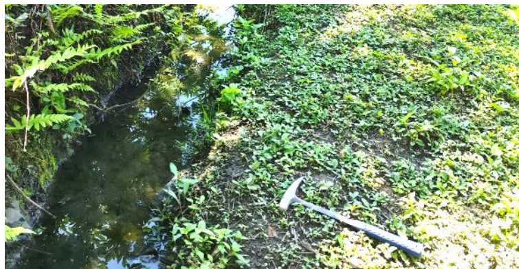
Figura 16. Canal perimetral sin recubrimiento ubicado en el contorno de la plataforma comunal. Ubicación: E: 736763, N: 9317960.
