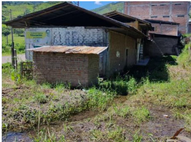
Figura 17. Viviendas afectadas por hundimiento. Ubicación: E: 736720, N: 9317963.
