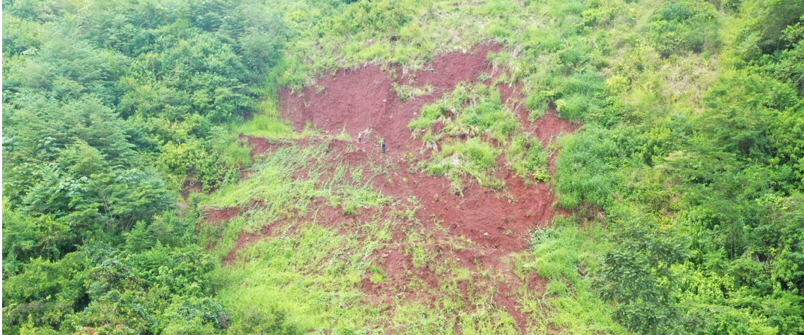
Fotografía 2. Muestra el escarpe principal con derrumbes en sus caras
