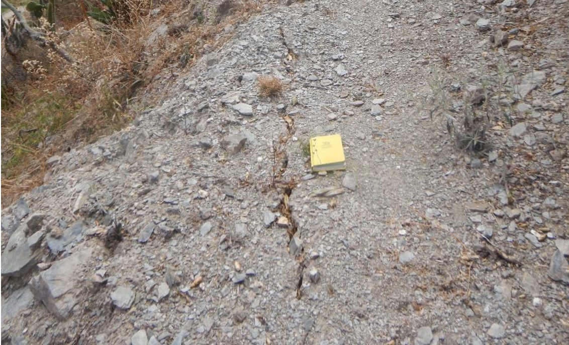
Fotografía 8. Presencia de grietas milimétricas, lo que es una evidencia que la masa se encuentra latente y podría generar desplazamientos.
