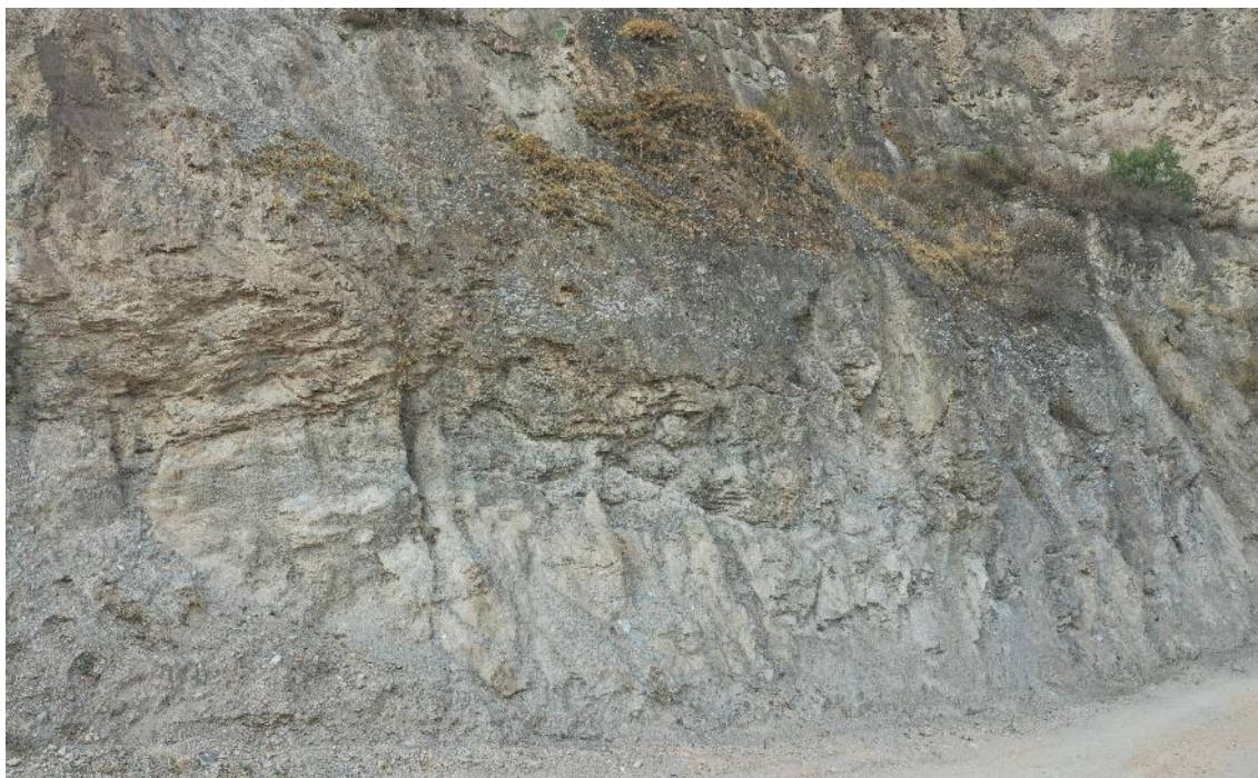
Fotografía 6. Vista de la ladera donde se muestra que el material coluvio-deluvial afectado por el agua de escorrentía, inestabiliza el talud en temporada de lluvias.
