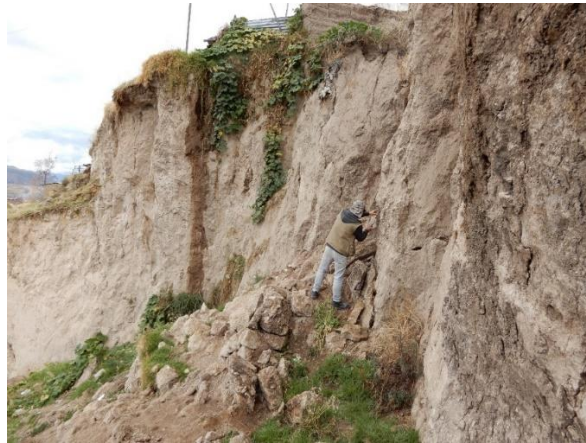
Fotografía 3: Presencia de humedad, proveniente de aguas de lluvia.
