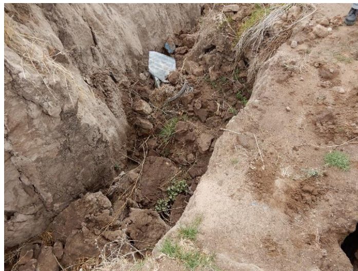
Fotografía 2: Agrietamiento con una profundidad visible de 4m y apertura de 1 a 1.5m.
