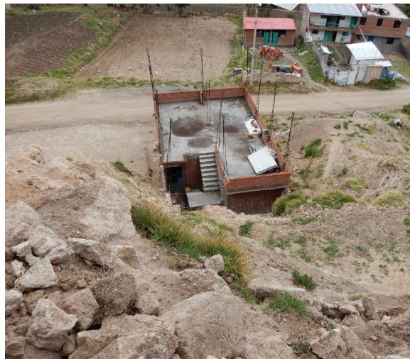
Fotografía 4: Vivienda en proceso de construcción, alzándose dentro del área de avance del deslizamiento.
