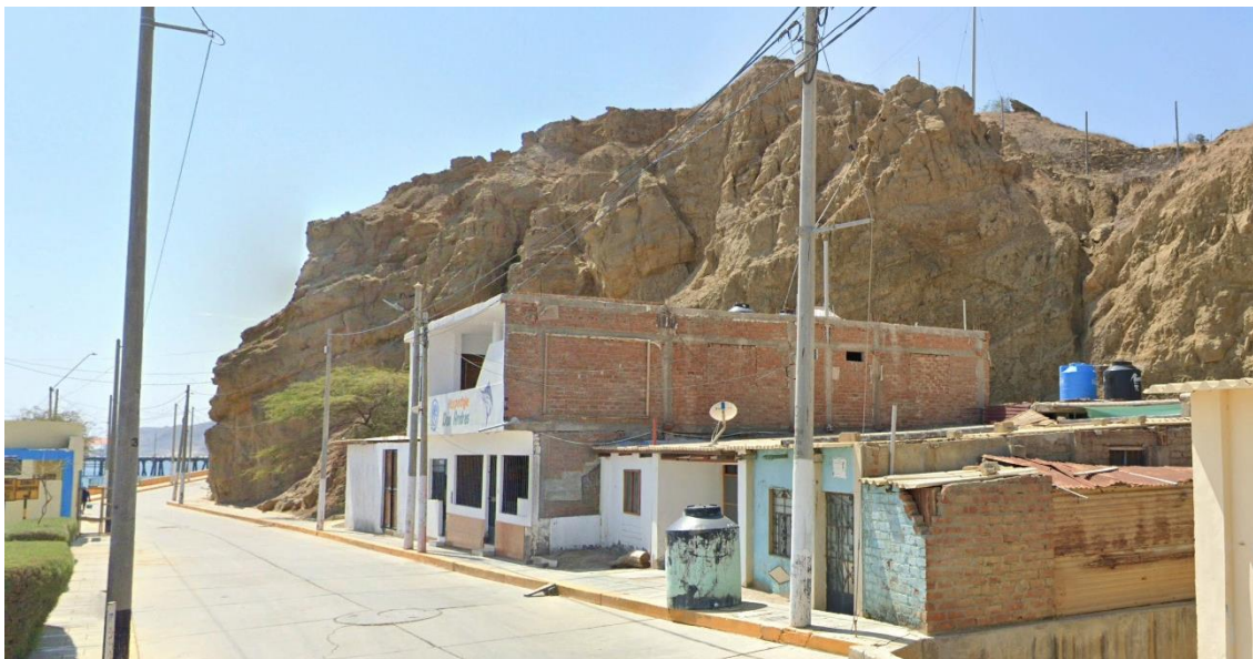
Figura 12. Acantilados con pendientes escarpadas en el borde costero del caserío Caleta Cabo Blanco.
