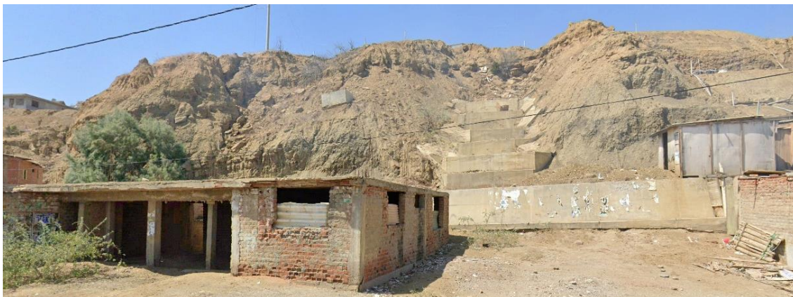
Figura 22. Vivienda abandonada afectada por flujos y caídas en la parte alta de la ladera.
