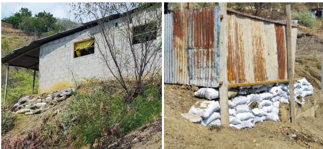
Fotografía 2. Erosión de los cimientos de viviendas en el sector San Martín de Porres.
