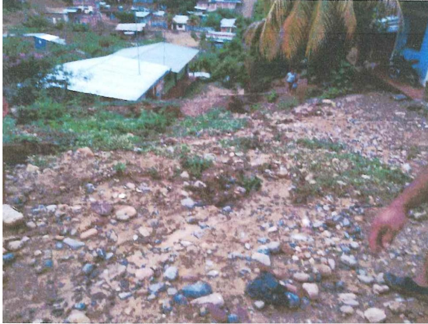
Fotografía 3. Jr. Belén del sector La Esperanza afectado por erosión en cárcava durante febrero del 2024. Fuente: Municipalidad Provincial de Utcubamba.
