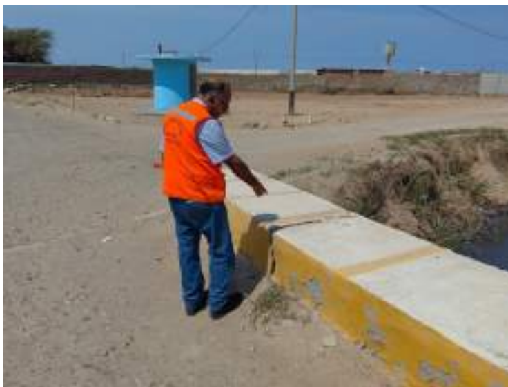
Fotografía 01: DAÑO ESTRUCTURAL EN EL PUENTE PEATONAL DE ACCESO A LA URB. LAS DUNAS.
