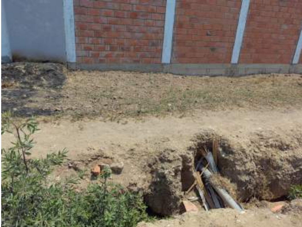
FOTOGRAFÍA 07: TUBERÍAS DE DESAGÜE PRINCIPAL CERCA A LA URB. LAS GARZAS, SE ENCUENTRAN EXPUESTAS
