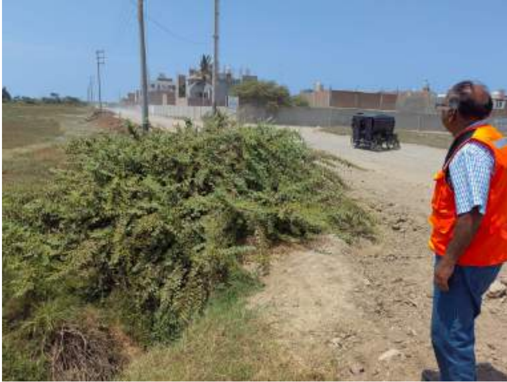
FOTOGRAFÍA 05: TRAMO DEL DREN 3110 – URB. LAS GARZAS SE ENCUENTRAN TOTALMENTE COLMATADAS
