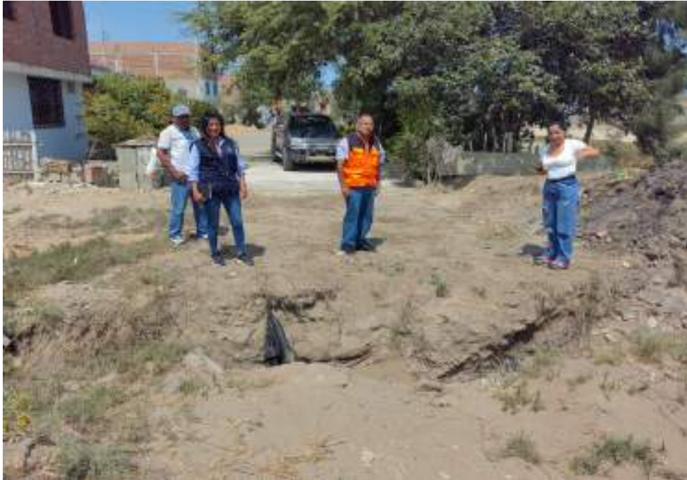
Fotografía 02: CAMINO DE VIGILANCIA DEL PEOT, INTERVENIDO POR LOS VECINOS DE MANERA INCIPIENTE PARA PROTEGER SUS VIVIENDAS.
