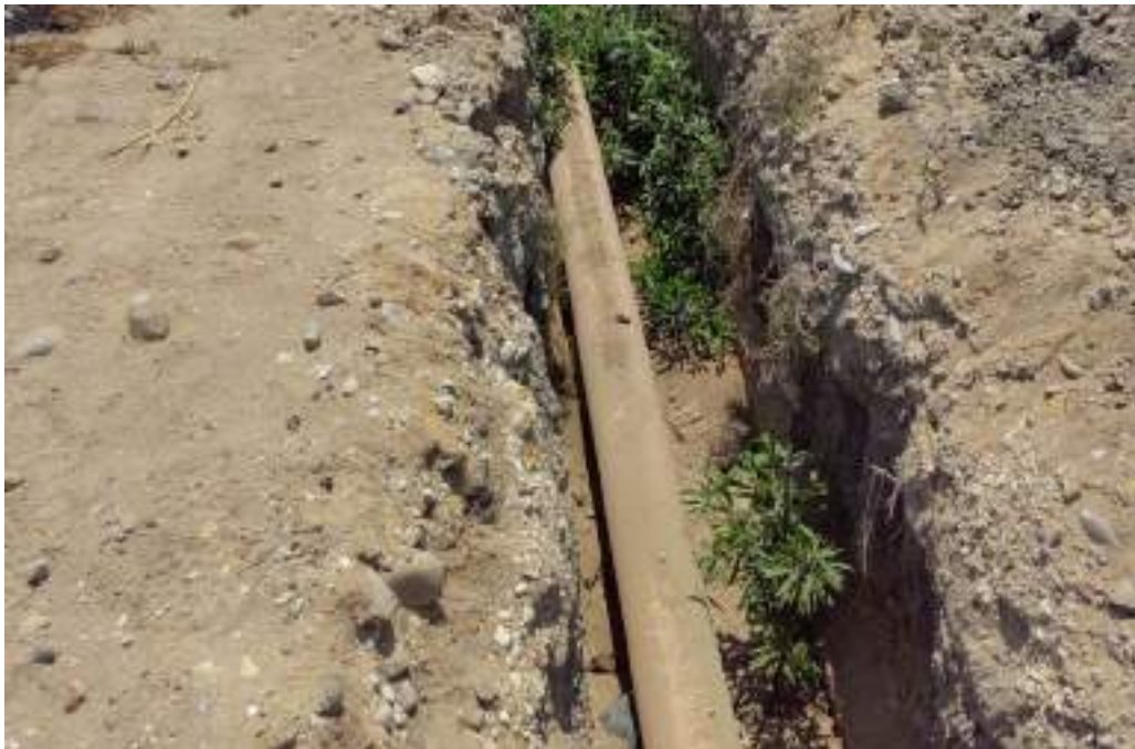
FOTOGRAFÍA 06: FIN DEL PRIMER TRAMO DEL DREN 3110 – URB. LAS GARZAS SE ENCUENTRAN TOTALMENTE COLMATADAS
