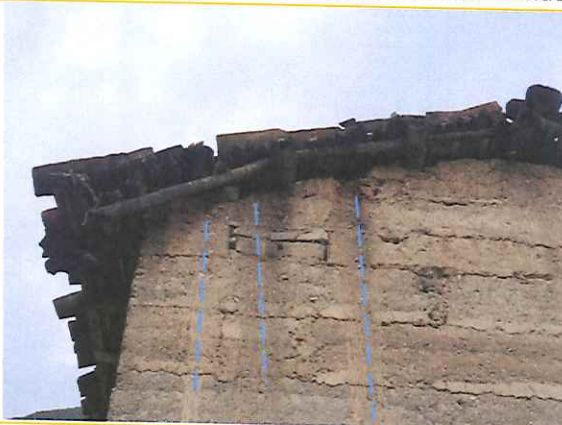
La delimitación en azul muestra pequeños rasgos o indicios que señalan la ocurrencia de lluvias intensas anteriores, los cuales denotan un proceso lento pero desgastante. Las vigas de soporte del techo mantienen su color natural y con escasos indicios de putrefacción. Asimismo, en campo se observó que tanto la fachada como el techo mantienen un equilibrio estructural.
