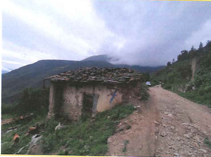
Fotografía tomada a una vivienda en el sector de Carhuajara, la cual presenta un estado de deterioro muy avanzado, se aprecia claramente que el lado derecho la fachada presenta un colapso parcial asociado con la pérdida del techo. Esta vivienda pertenece a un poblador que se ha visto en la necesidad de abandonar y usar esta vivienda como almacén.
