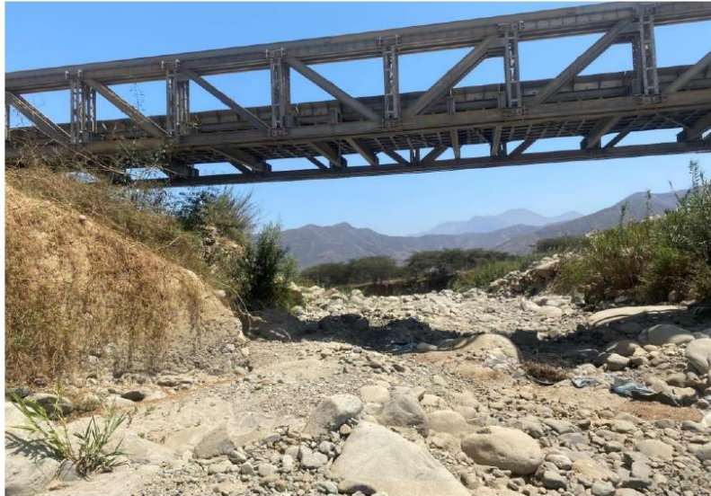
FIGURA N° 01: TRAMO CRÍTICO EN EL RÍO SIMBAL, EN EL SECTOR PUENTE COLLAMBAY, DISTRITO DE SIMBAL, PROVINCIA DE TRUJILLO, DEPARTAMENTO DE LA LIBERTAD.
