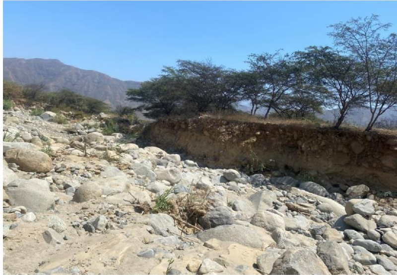
FIGURA N° 02: SECTOR DEL CAUCE CON PRESENCIA DE ROCAS SEDIMENTADAS PRODUCTO DE HUAYCOS EN EL RÍO SIMBAL SECTOR
