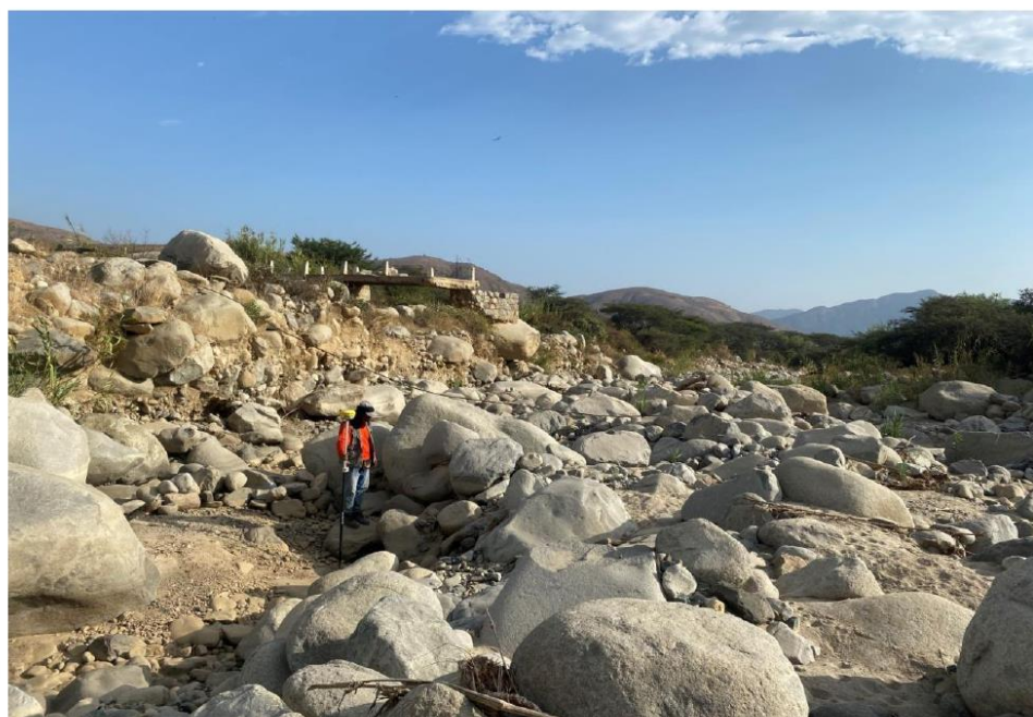
FIGURA N° 03: EN LA TEMPORADA DE MAXIMAS AVENIDAS, EL RÍO SIMBAL SE DESBORDA EN ESTE TRAMO DEL SECTOR PUENTE VIEJO, ARRASANDO CON TODO LO QUE ENCUENTRA A SU PASO, ACA SE VE LA EROSION DE LA VIA ADYACENTE.
