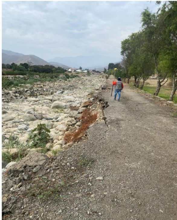
FIGURA N° 03: EN LA TEMPORADA DE MAXIMAS AVENIDAS, EL RÍO LA CUESTA SE DESBORDA EN ESTE TRAMO DEL SECTOR PEDREGAL, ARRASANDO CON TODO LO QUE ENCUENTRA A SU PASO, ACA SE VE LA EROSION DE LA VIA ADYACENTE.
