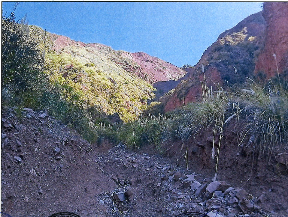
Fotografía 23: Quebrada Hatun Huayco, material suelto susceptible a ser arrastrado por las aguas de escorrentía y generar flujos.
