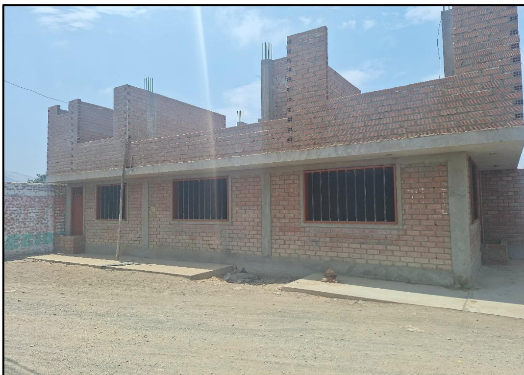
Fotografía19. Fotografía 08. Viviendas expuestas al peligro por inundación por el desborde del río de Huarmey - Zona crítica - HH-005-I
