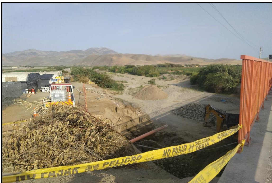
Fotografia28. Vista del puente Culebras expuesto a inundación por el desborde del río Culebras
