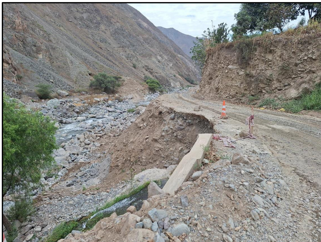
Fotografia42. Trocha carrozable que se ha visto afectada por el desborde del río
