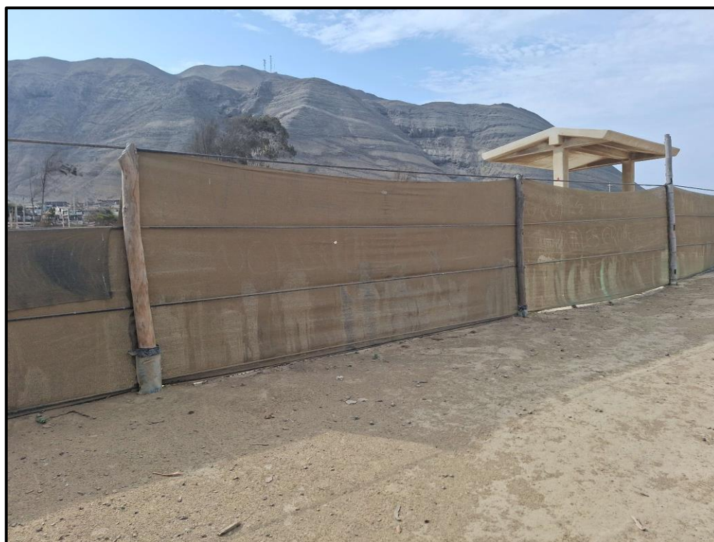
Fotografia12. Vista de la huella de inundación con una altura aprox. de 0.80 cm que afectó la zona – Zona crítica HH-003-I
