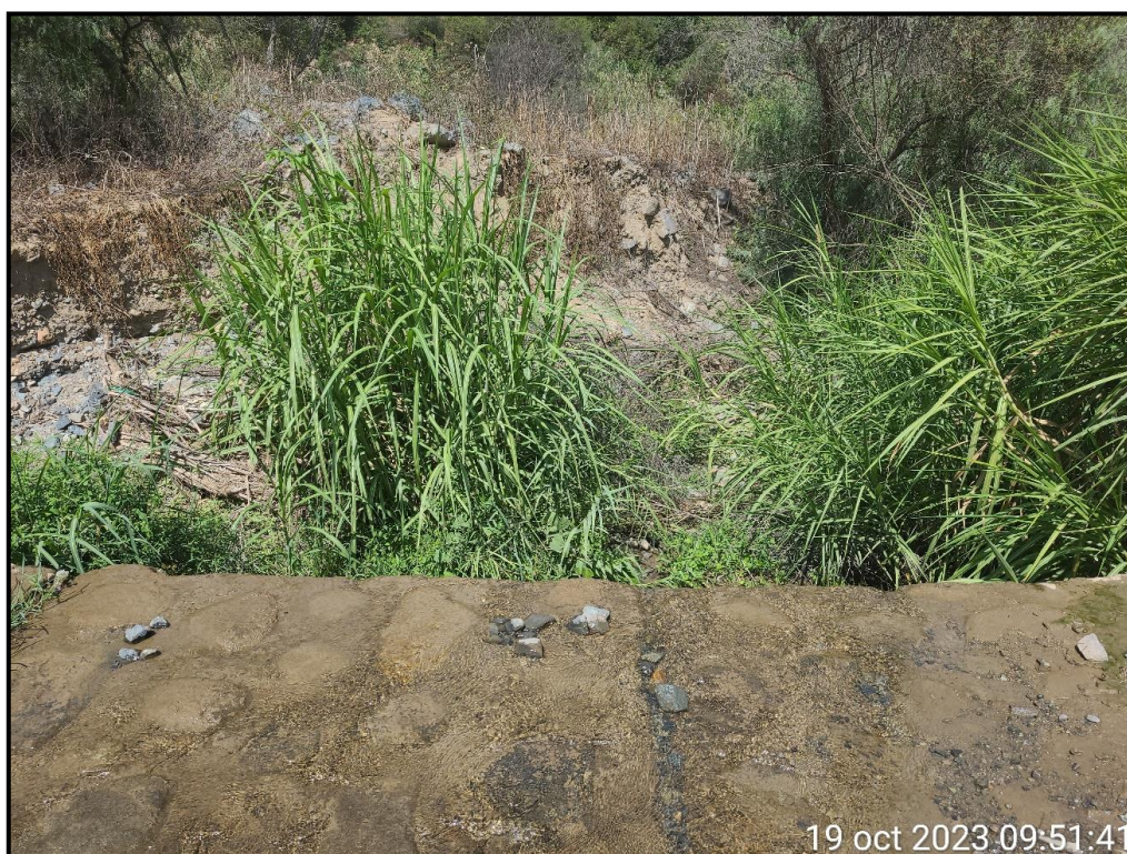
Fotografia52. Trocha carrozable expuesta al peligro por flujo de detritos frente a la activación de la quebrada en el centro poblado Pirauya - Zona crítica – HCO-002-M
