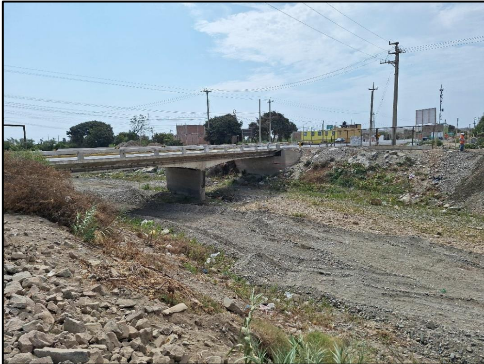
Fotografia13. Puente ubicado en la carretera Panamericana que se ha visto afectado por desborde del rio Huarmey en la ocurrencia de eventos anómalos - Zona crítica - HH-004-I
