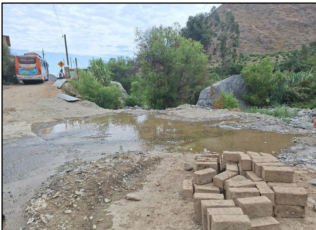
Fotografia41. Trocha carrozable que se ve afectada por la activación de la quebrada - Zona crítica — HHU-006-I
