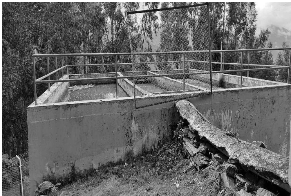
Ilustración 8: Planta de tratamiento de aguas residuales del distrito de Huacaybamba con Tanque Imhoff.
