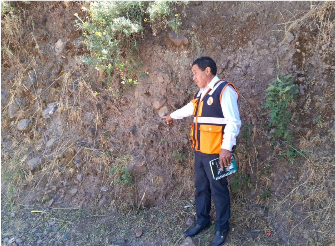
Fotografía 1. Muestra parte del escarpe principal del deslizamiento rotacional inactivo latente.
