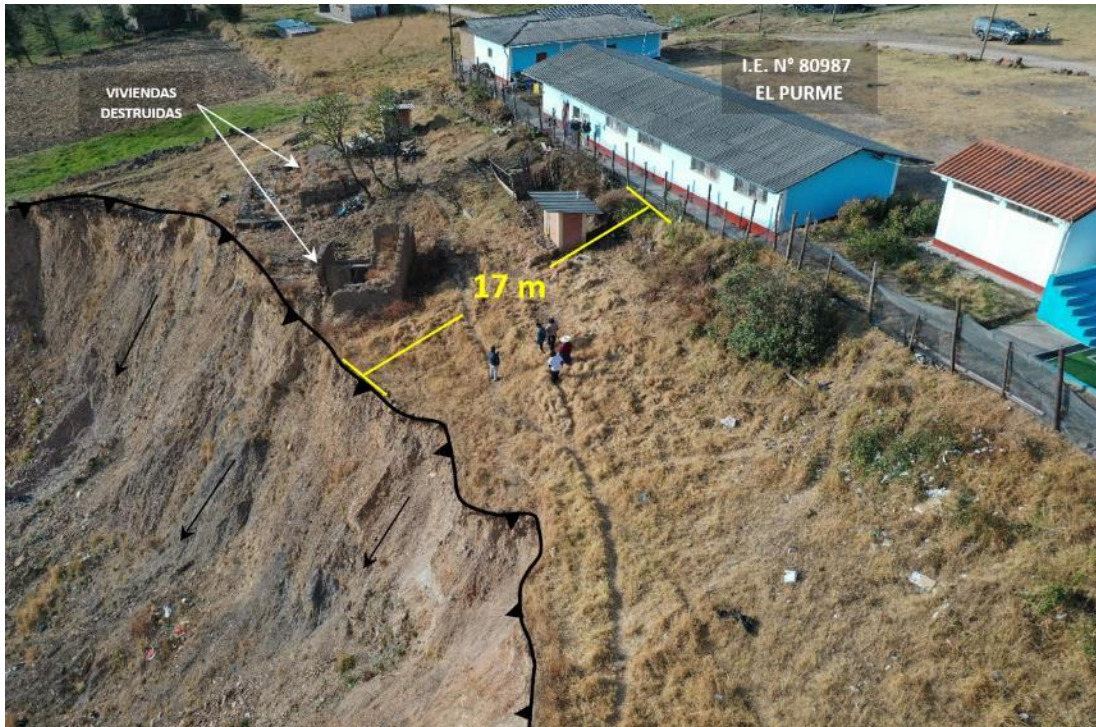
Figura 15. Se aprecia la distancia de la corona del deslizamiento a la Institución Educativa de 17 m.
