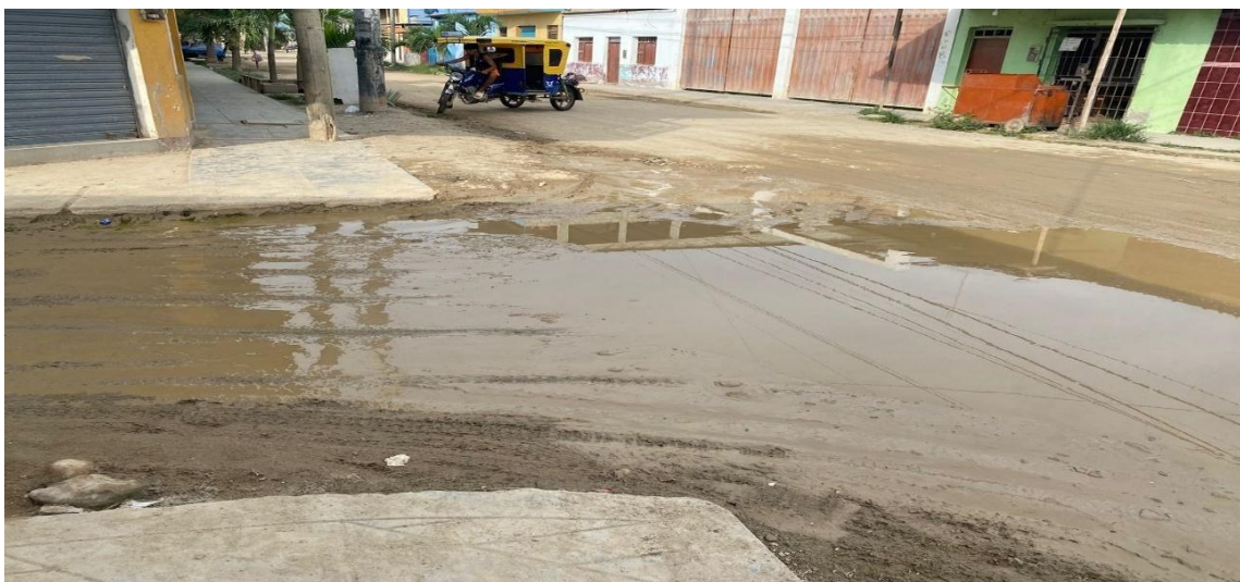
Figura N° 15. Calle contigua al área del proyecto con registro de aniegos.
