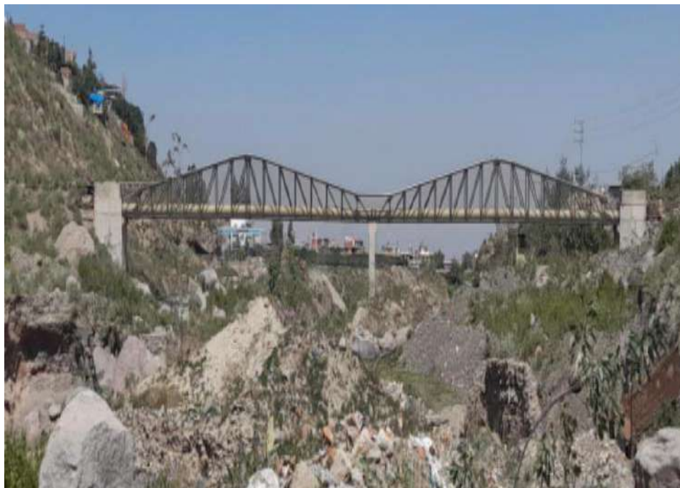
Ilustración 22 – Vista Panorámica de la Quebrada San Lázaro donde se aprecia un acueducto.
