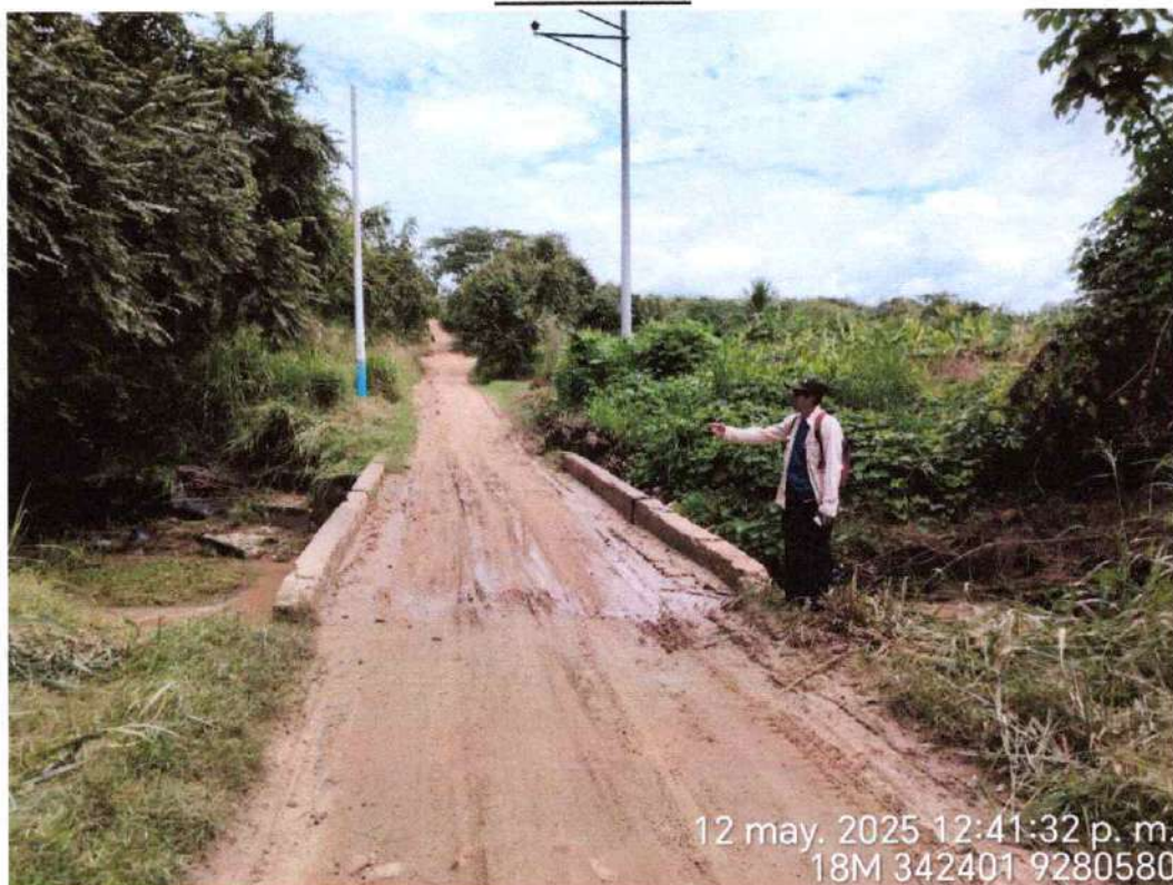
Punto inicial zona crítica de la ficha N°004 – Sector Quebrada Shupishiña
