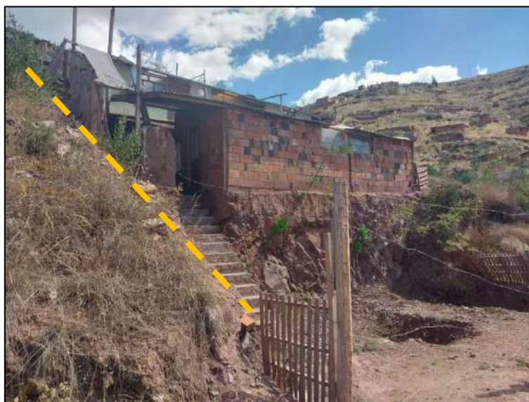
FOTOGRAFÍA 8: CARCAVA PRESENTE EN EL LOTE B-18
