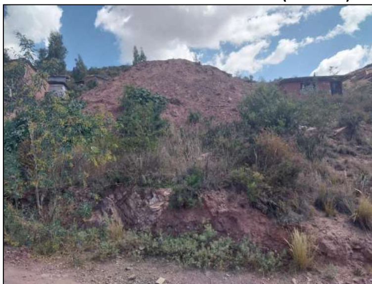
FOTOGRAFÍA 1: MATERIAL EXCEDENTE (RELLENO)
