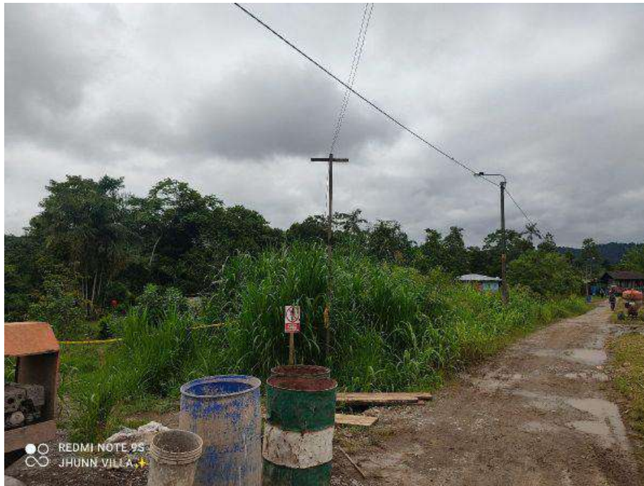
FOTOGRAFIA N°7. IMAGEN DE POSTES DE LUZ Y RED ELECTRICA
