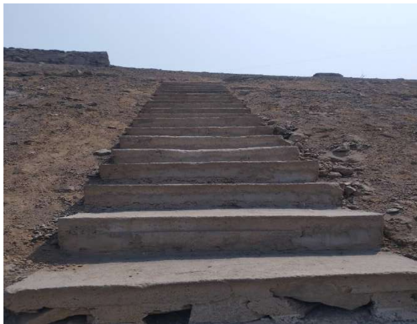
Escalera incompleta y en mal estado en la URB LAS TERRAZAS DEL PUEBLO
