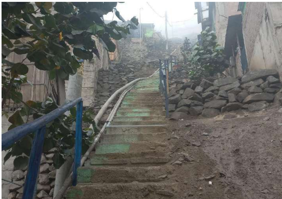
Evidencia de escaleras sin barandas en ambos lados en el AAHH VIRGEN DE FATIMA
