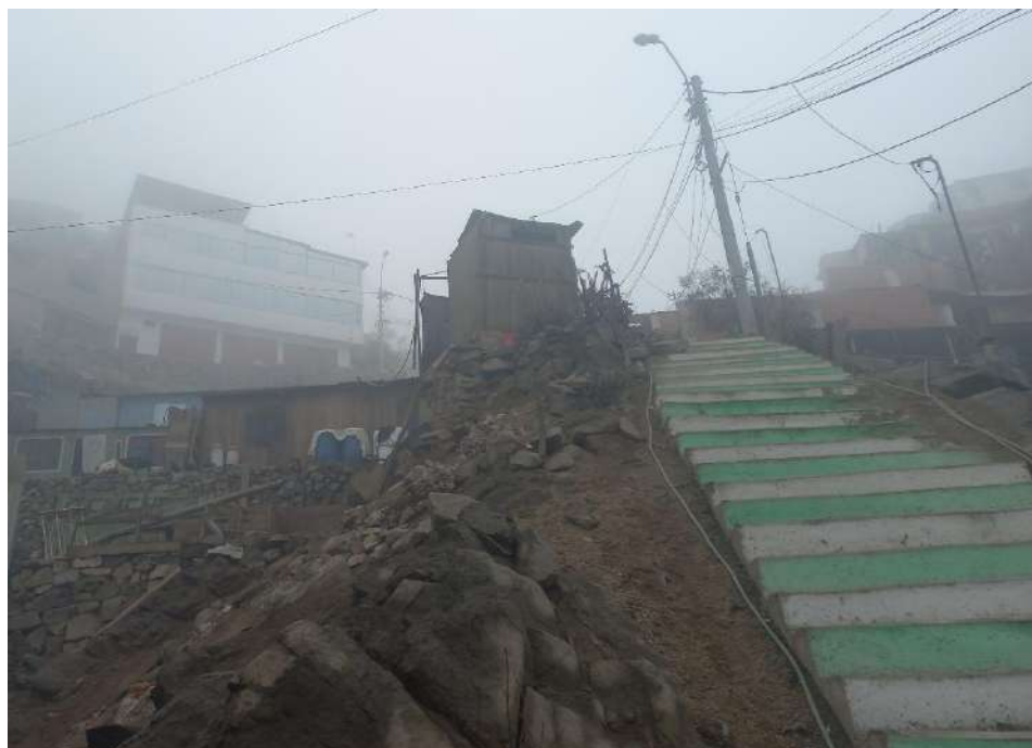
Evidencia de escalera sin barandas en el AAHH VIRGEN DE FATIMA.
