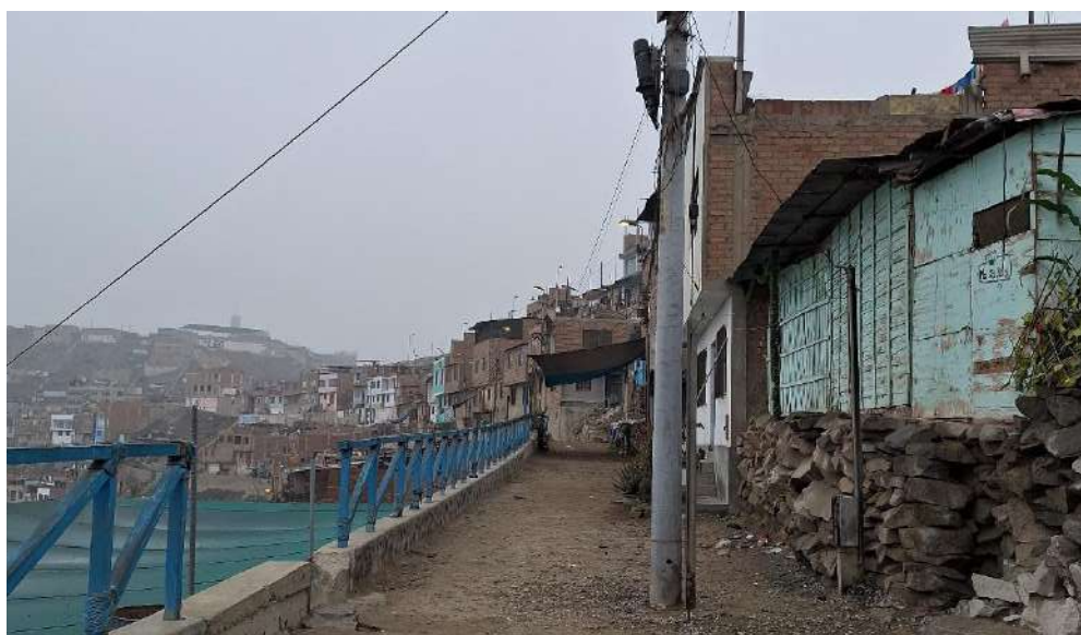
Se observa vivienda construida con madera y en mal estado de conservación en el San Pedro de Ate.
