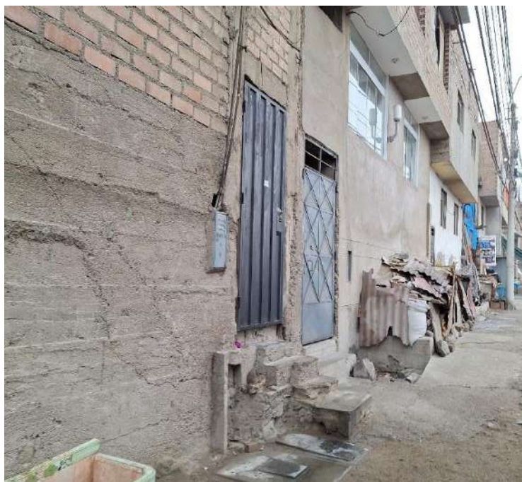
Vivienda con acceso elevado mediante escalera en mal estado en el AAHH San Pedro de Ate.
