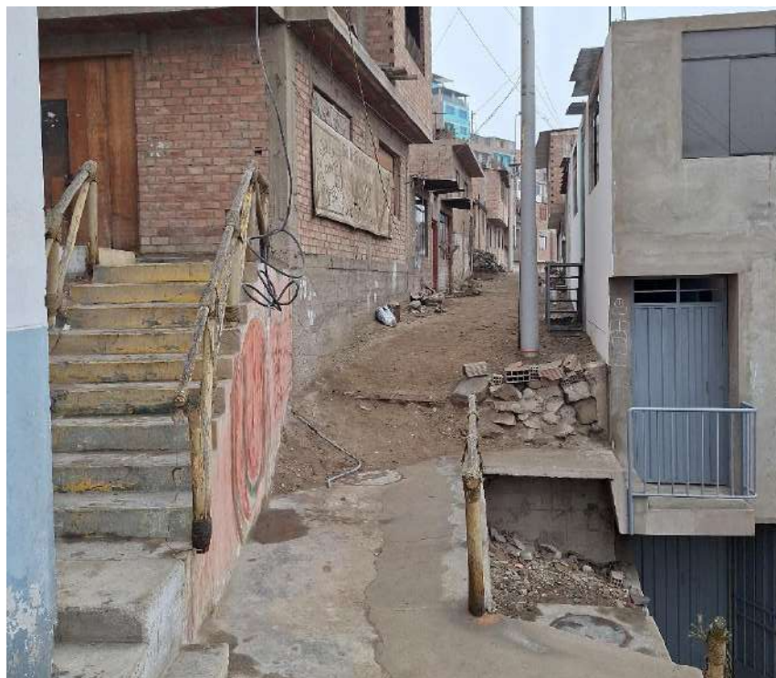
Se observa barandas en mal estado cerca de viviendas del AAHH San Pedro de Ate.
