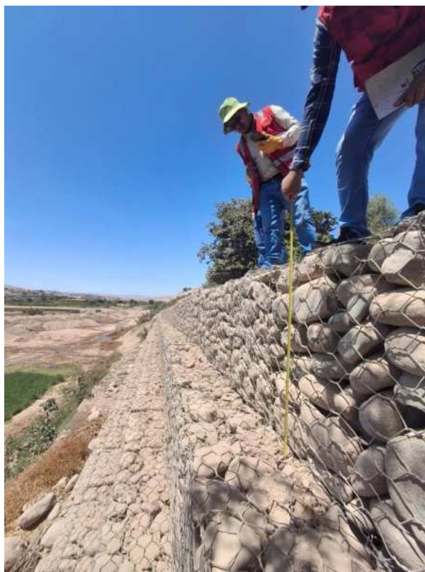
FOTO 20: VISTA DE MUROS DE GAVIONES EN LAS LADERAS DEL RÍO HUARACANE
