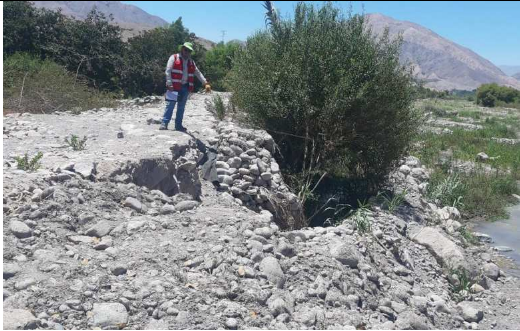
Visita de campo a zonas afectadas por el ultimo ingreso del rio Huaracane, donde se aprecia gaviones deteriorados.
