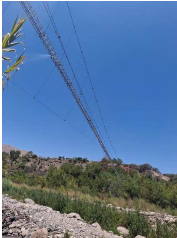
ILUSTRACIÓN 1: VISTA DE SISTEMA HIDRAULICO AL INTERIOR DEL PASE ESTRUCTURAL AEREO.
