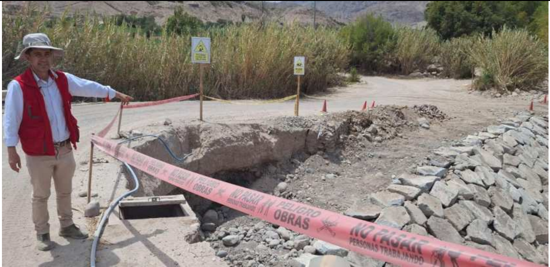
Visita de campo al puente Huaracane con la ejecución de trabajos de reforzamiento tipo enrocado en vía de acceso afectada por el ingreso del río Huaracane
