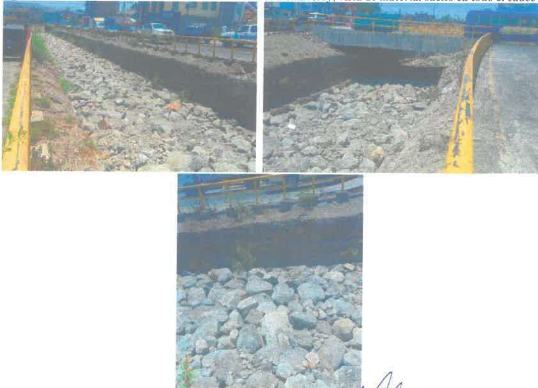
Imagen 55: Estado de la torrentera a la altura de Alameda Salaverry, vista de material suelto en todo el cauce
