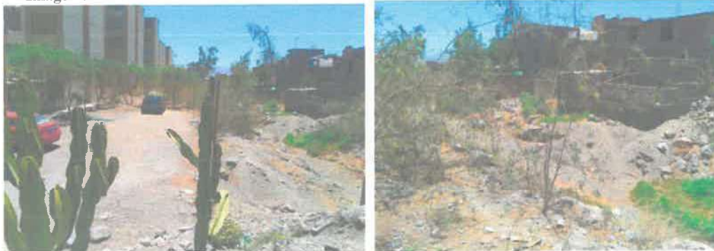
Imagen 50: Insuficiencia o ausencia total de muros de contención en las márgenes de la quebrada
