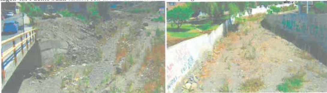
Imagen 48: Puente Juan XXIII, con exceso de material suelto y angostamiento de la sección de la quebrada
