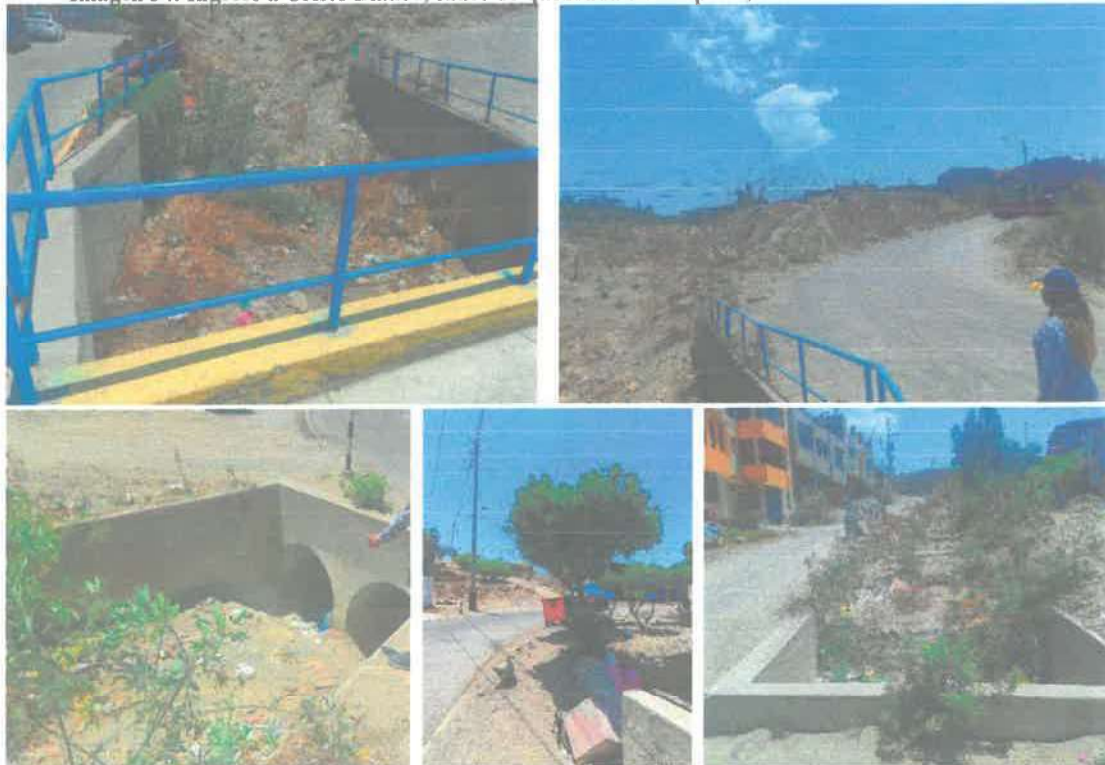
Imagen 34: Ingreso a Cristo Blanco, cauce de quebrada sin limpieza, delimitado con muros
