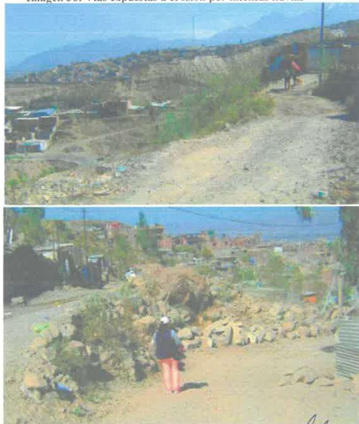
Imagen 36: Vías expuestas a erosión por intensas lluvias
