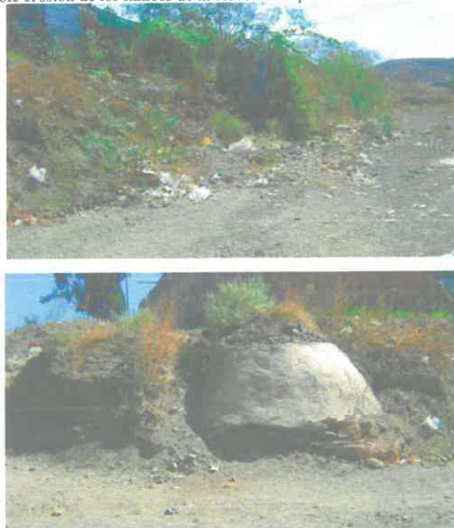
Imagen 57: Posible erosión de los flancos de la torrentera que sirven de base a las viviendas
