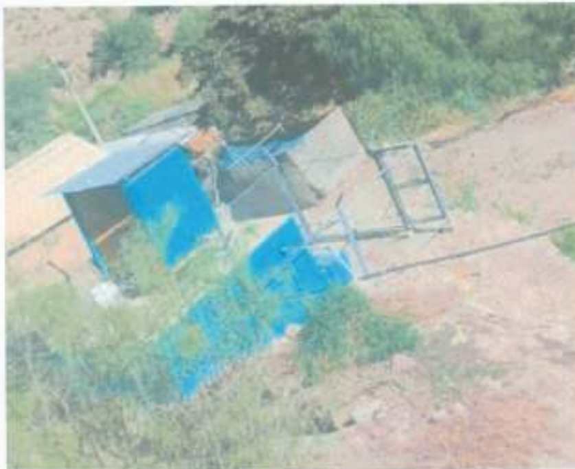
Fotografía Identificación de Reservorios
