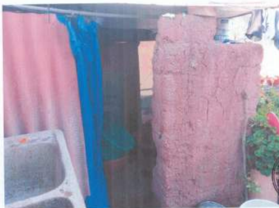
Fotografía 7 Ambiente precario dentro del lote para los servicios higiénicos, conectado a la red de alcantarillado.
