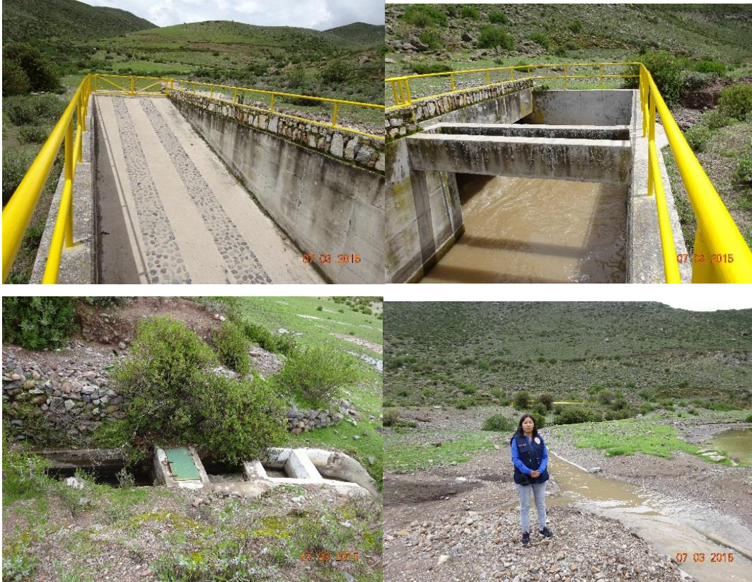
Figura 37: Cámara de sedimentación del canal principal de Majes y canal secundario de Cabanaconde.
