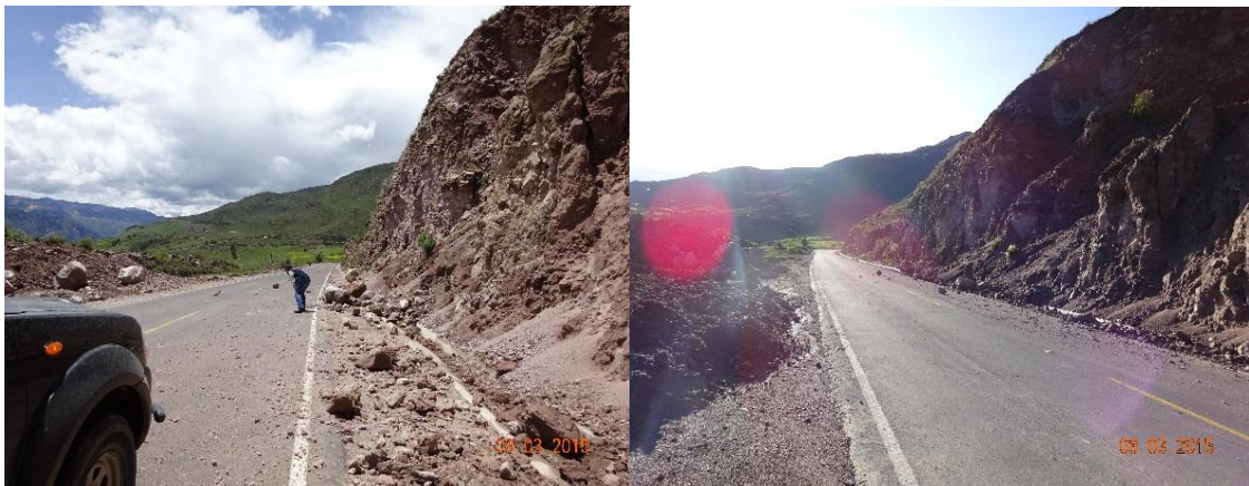
Figura 36: Vías de acceso entre Pinchollo y Cabanaconde afectadas por el derrumbe de roca y piedra producto del movimiento sísmico y lluvias intensas.
