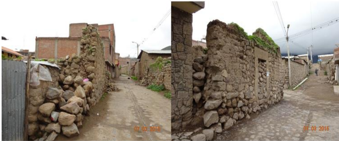
Figura 13: Fotografía de viviendas hechas de piedra con mortero, cuya precariedad las predispone al colapso ante un leve movimiento como el generado por el pasado sismo del 28 de febrero del presente.
