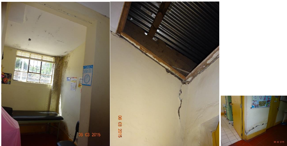
Figura 24: Daños estructurales que presenta el Centro de salud Cabanaconde (categoría 1-3).
