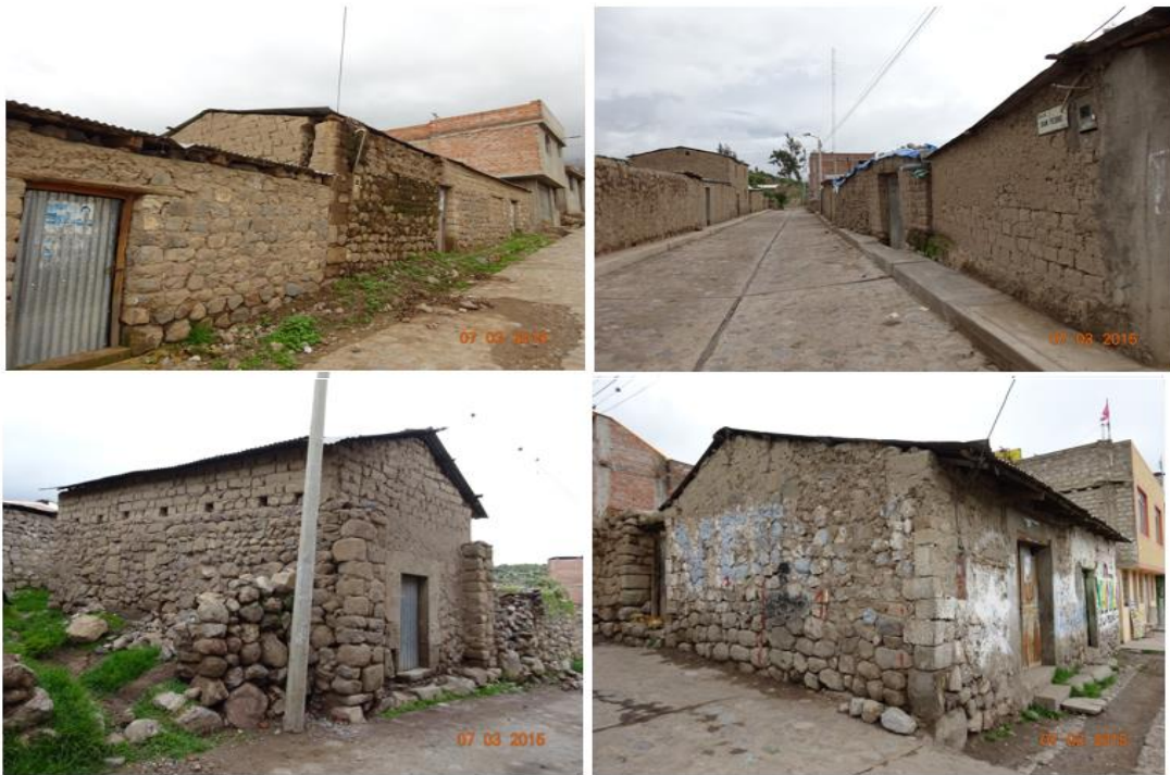
Figura 12: Fotografía de típicas viviendas del distrito de Cabanaconde. En su mayoría presentan erosión del mortero y fisuras que pueden ser reparadas y/o reforzadas.
