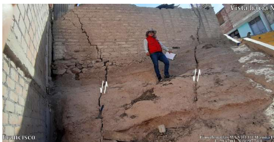
Figura 16: Fallamientos en el sector San Francisco
