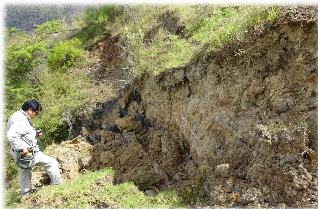
Foto N° 02: Plano de deslizamiento en sector Alma Pampa.
