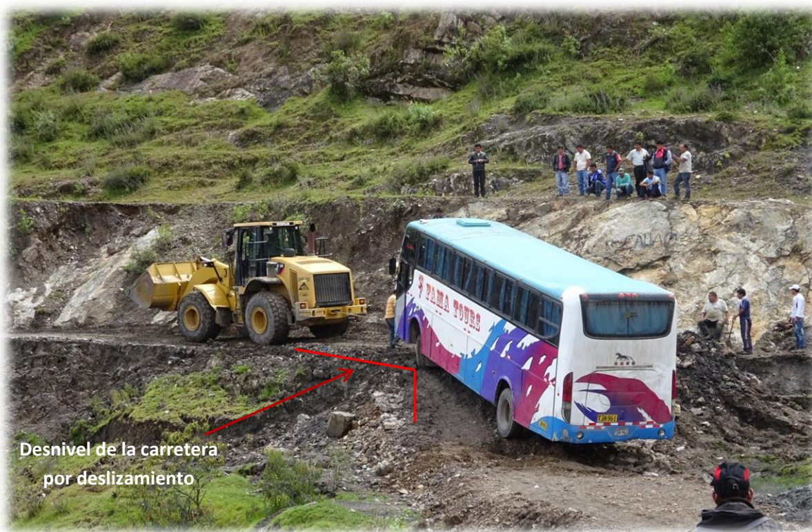
Foto N° 08: Desnivel de la carretera Socosbamba – Piscobamba ocasionado por el deslizamiento.
