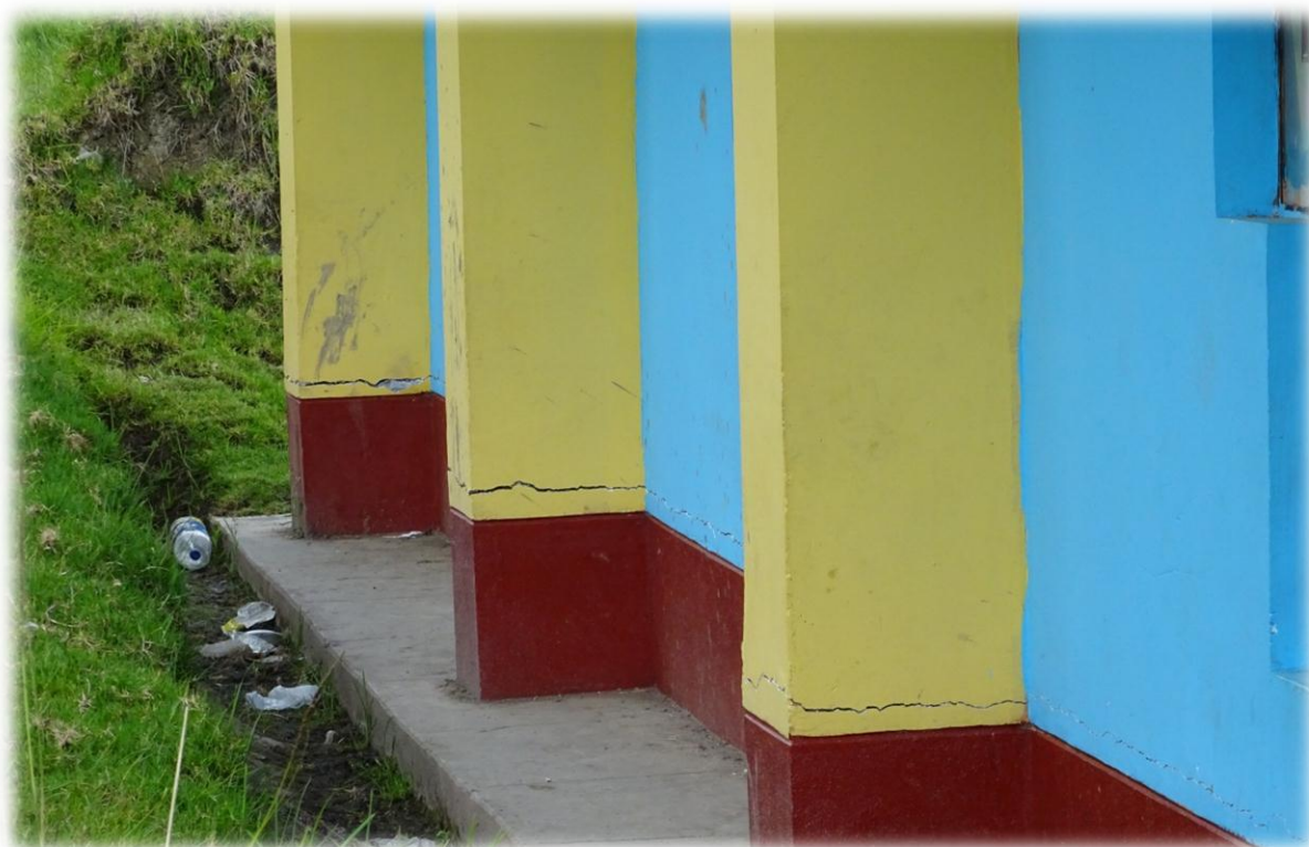
Foto N° 10: Grietas en las columnas de la I.E. Emilio Egusquiza Auranga (primaria).
