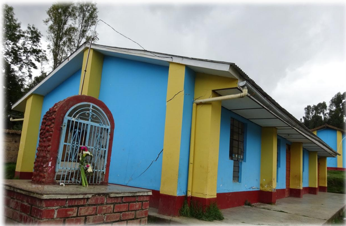
Foto N° 09: Grietas en las paredes de la I.E. Emilio Egusquiza Auranga (primaria).
