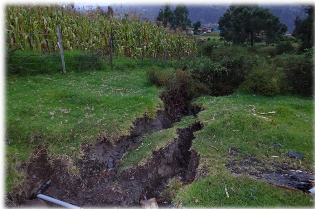
Foto N° 04: Grieta con un ancho de 0.60 m producto del deslizamiento en sector Sacachay.
