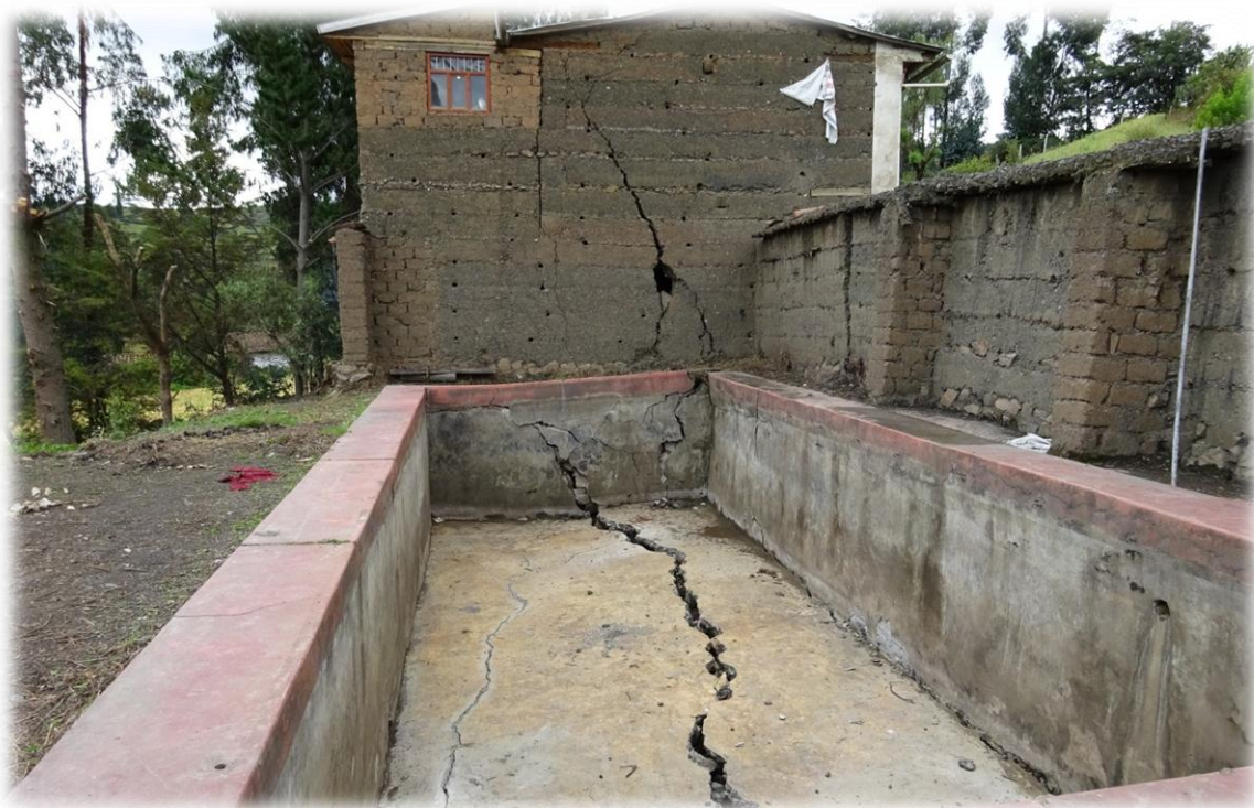
Foto N° 07: Daños en la vivienda del Sr. Juan Antonio Rodriguez Eguisquiza.
