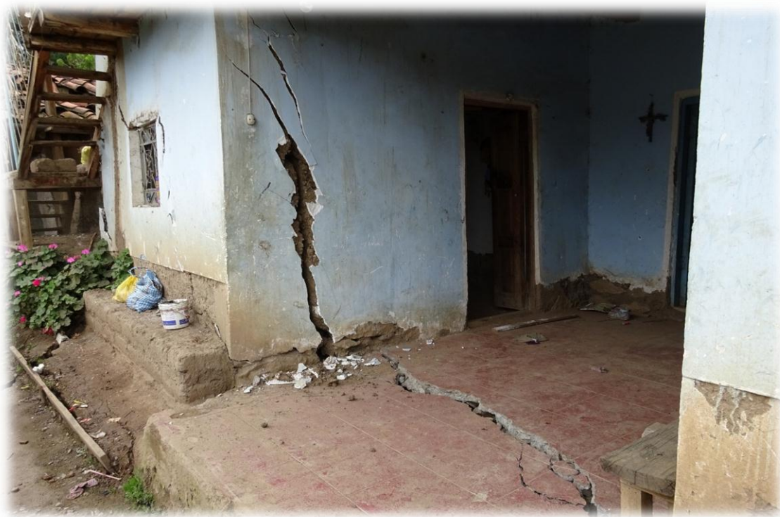
Foto N° 02: Vivienda afectada del Sr. Juan Antonio Rodriguez Egusquiza.
