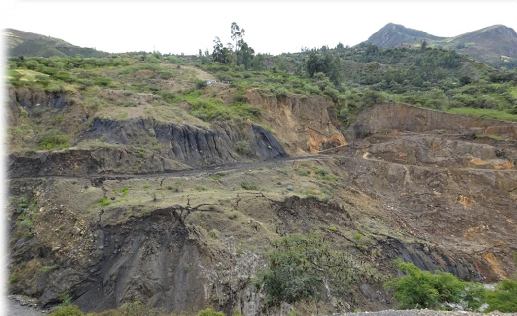
Foto N° 01: Grietas que presenta la carreta de acceso al centro poblado de Socosbamba y Piscobamba.
