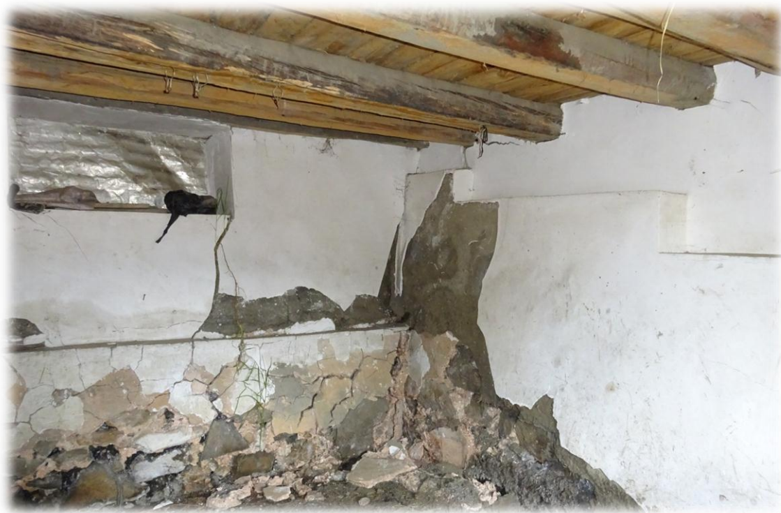
Foto N° 05: Estado de la vivienda del Sr. Eliseo Domínguez Agüero en el sector Rosas Pampa.
