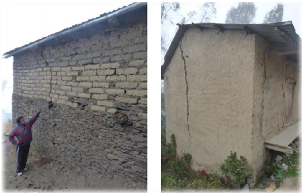
Foto N° 01: Viviendas con fisuras en las paredes.
