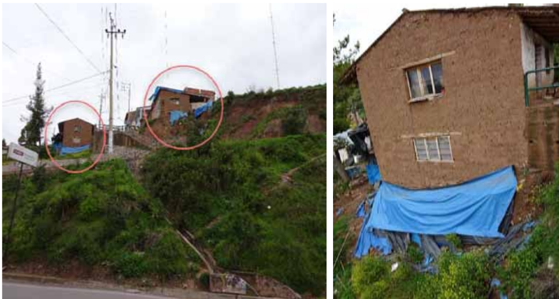
Figura 17: Viviendas ubicadas en zonas de alta pendiente, con exposición a la erosión pluvial. Algunas son cubiertas con plásticos de color azul a fin de protegerlas de las lluvias intensas. Presentan inestabilidad y alta vulnerabilidad por exposición y fragilidad.
