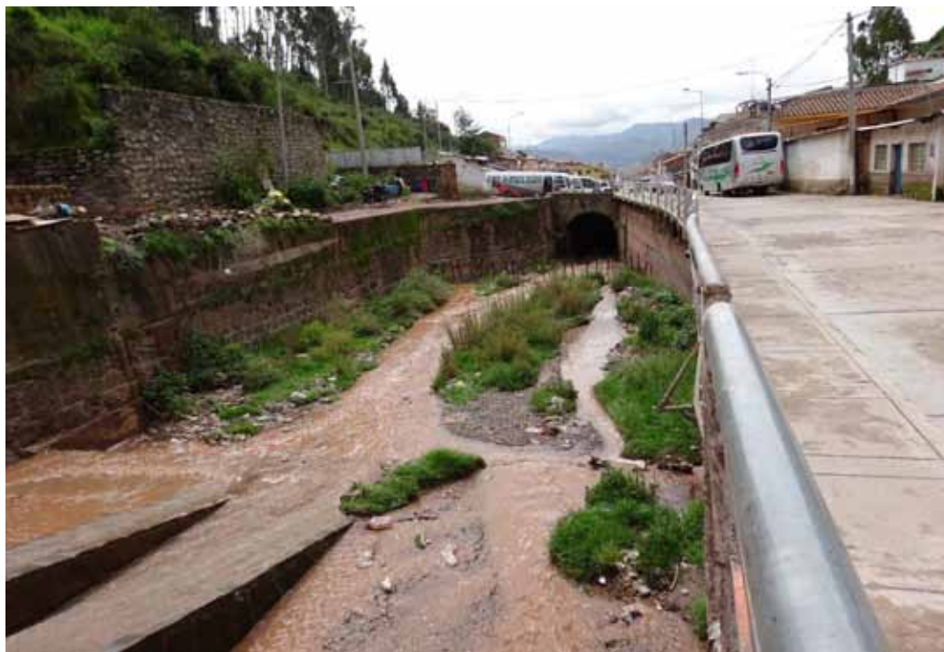
Figura 19: Gaviones y diques para canalizar las aguas del río Saphy, el cual representa un alto peligro para la zona del centro histórico de producirse deslizamientos, embalses y posterior desembalse. Su canalización pasa por las calles Plateros, Plaza de Armas, Av. El Sol hasta desembocar en el río Huncaro; a la altura del terminal terrestre.
