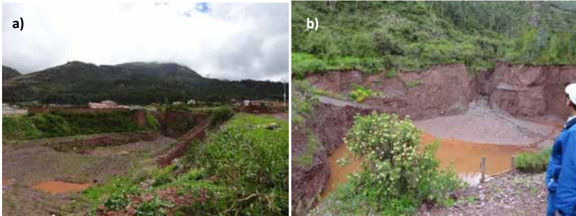
Figura 12: Disipadores de energía cerca de las urbanizaciones de Larapa y Santa María. a) Corresponde al disipador 1 y b) Corresponde al disipador 2, en donde se descarga los flujos de detritos y lodo que se acumulan en el tiempo. Existencia de viviendas alrededor del disipador número 1. Material compuesto por gravas, arenas y arcillas. Urbanizaciones de Larapa, Cachimayo y Santa María son las más expuestas ante posible deslizamiento.
