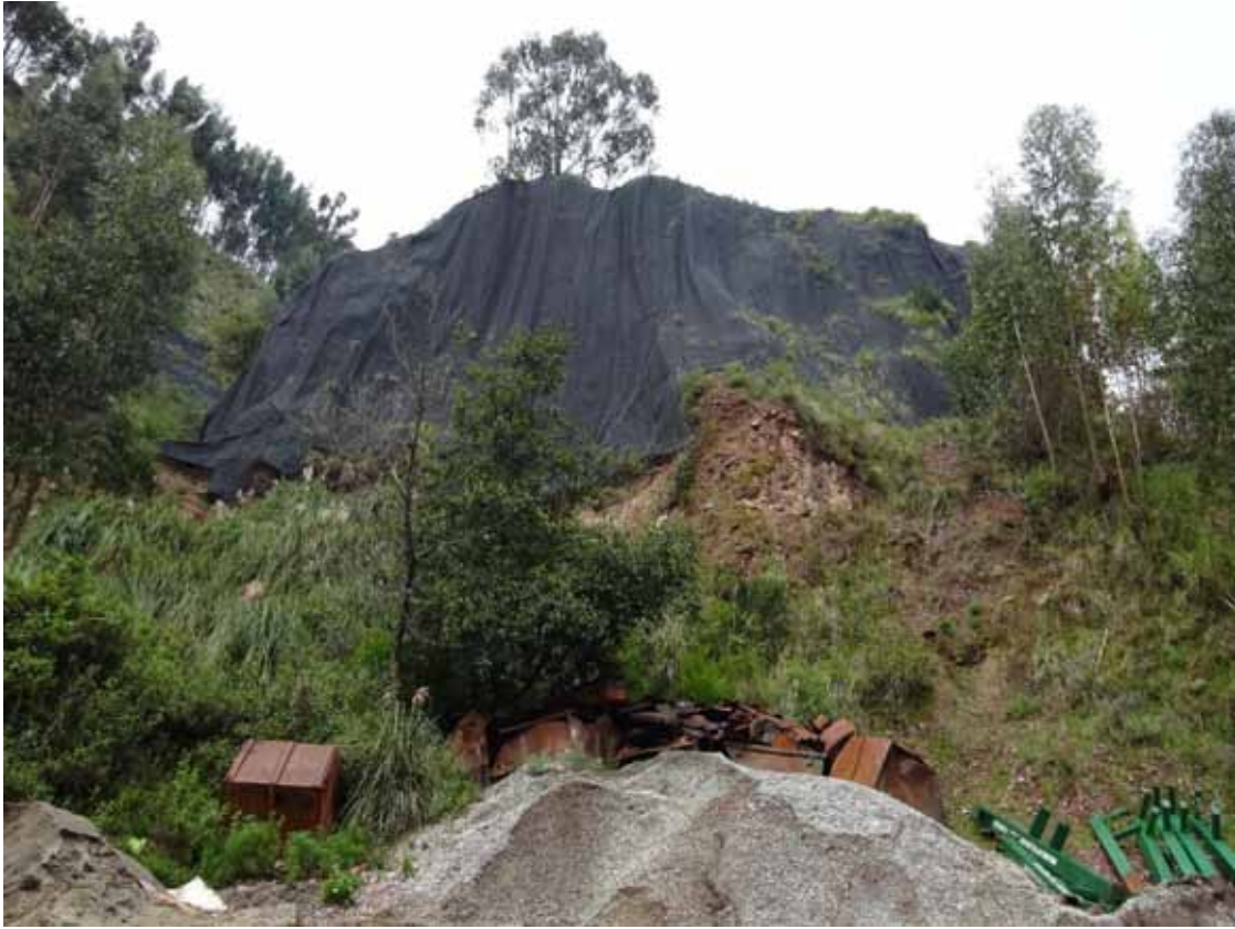
Figura 20: Zona de derrumbe y uso de medidas de protección mediante el uso de geomallas, ubicado dentro del campamento municipal de la provincia de Cusco.
