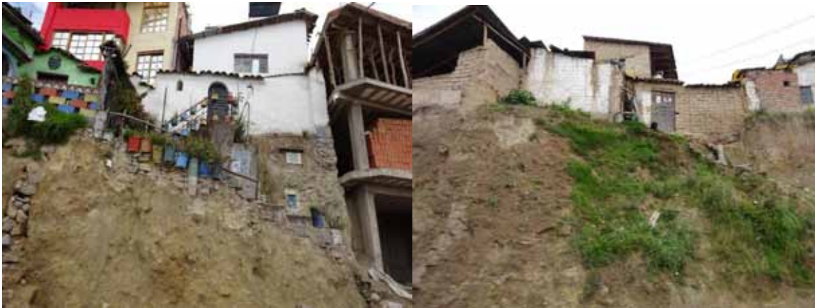
Figura 14: Viviendas al borde del talud, en la margen derecha de la vía principal. Presentan vulnerabilidad alta por exposición y fragilidad. La mayoría son viviendas de adobe con fisuras y grietas con asentamientos que son recurrentes en época de lluvia. Urgen medidas de estabilización del talud.
