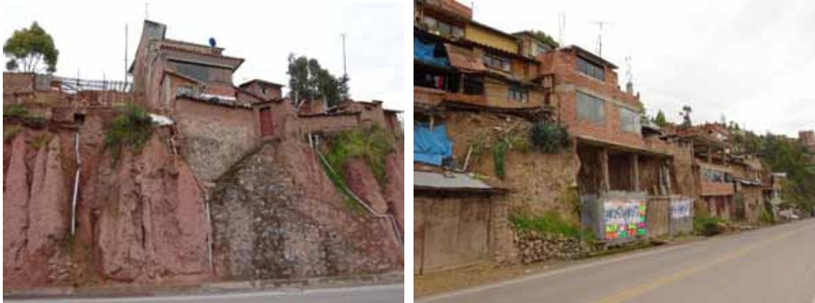
Figura 15: Viviendas ubicadas al extremo de la vía principal. Se observa erosión del talud por la acción de las lluvias intensas, dejando expuestas de las redes de agua. Viviendas de concreto estabilizadas y soportadas únicamente por columnas.
