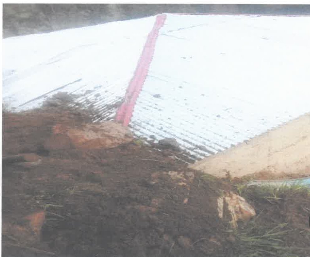
Vista N. 05: Se observa la zona crítica identificado por peligro de deslizamiento. Esta condición de peligro ha sido registrada y descrita en la Ficha Técnica PD-02.
