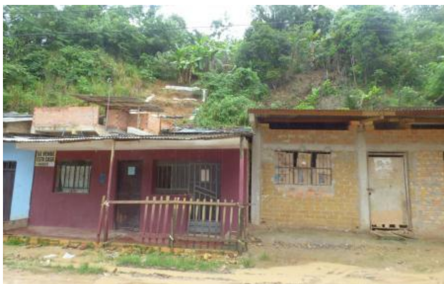
Foto 13. En la parte posterior de la vivienda han banqueteado el talud, con la finalidad de estabilizarlo.
