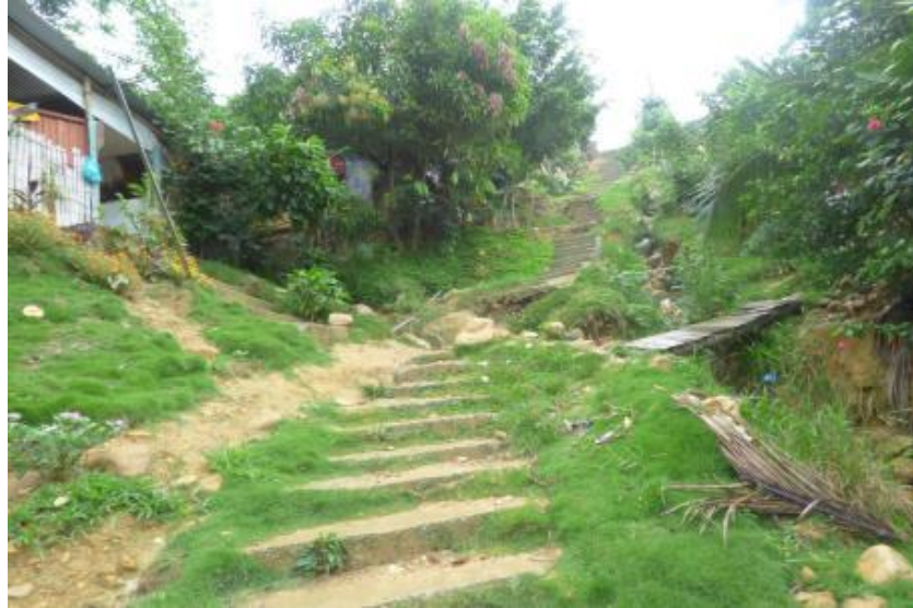
Foto 9. Se aprecia el proceso de erosión que está afectando a la vía de acceso peatonal.
