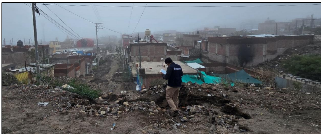
Fotografía 10. Socavamiento en las calles del sector Y' Alto Selva Alegre.
