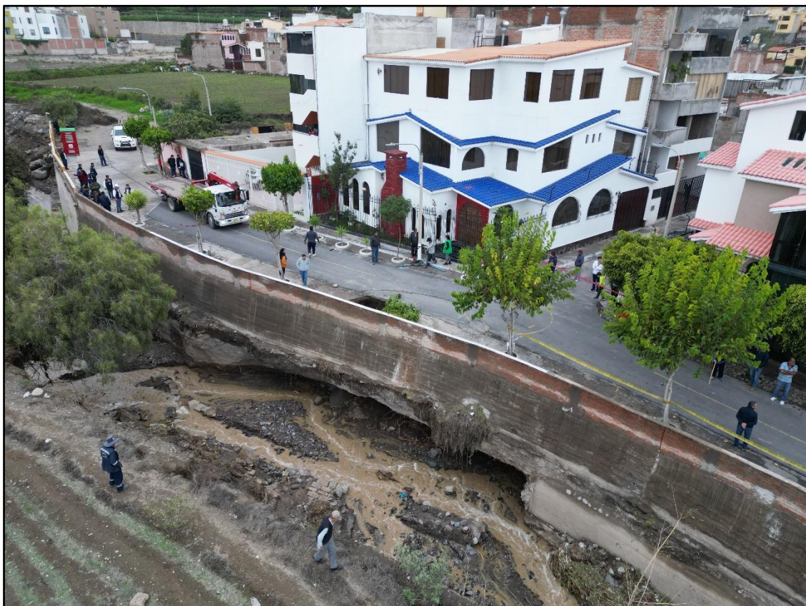
Fotografía 8. Socavamiento en el cauce de la quebrada Chullo, en el sector Avidge en el distrito Cayma, cerca al parque de la urbanización Avidge.
