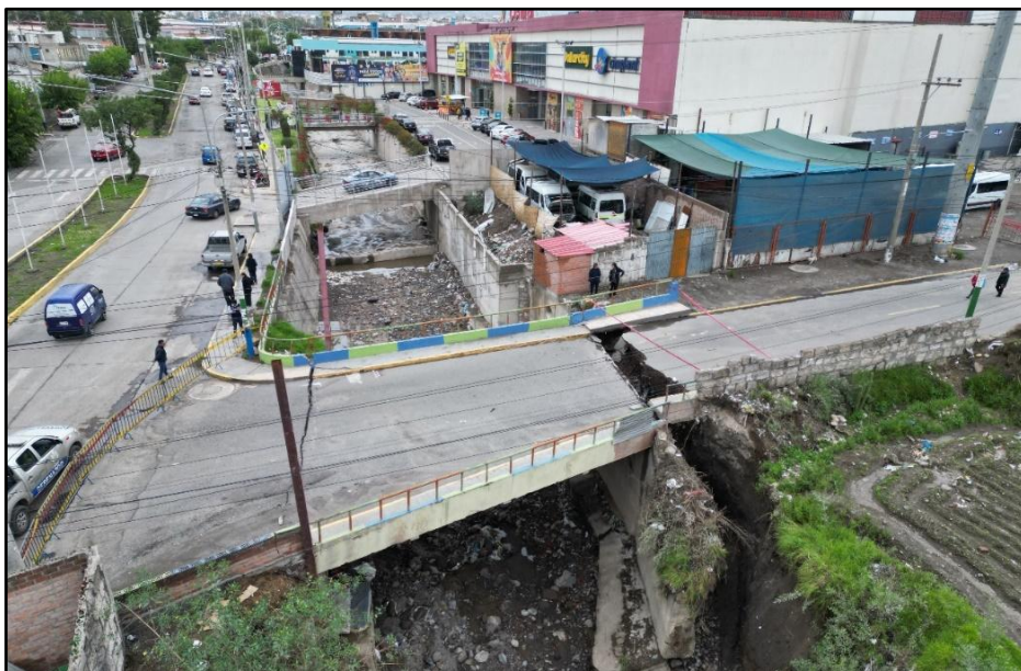
Fotografía 14. Quebrada Los Incas, parte baja, en el cual el pilar izquierdo del puente fue erosionado.
