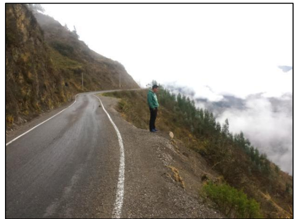
Foto 5: Escarpe E2, que se encuentra activo pendiente abajo de la vía asfaltada de acceso a la ciudad de Sihuas.
