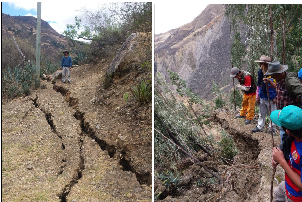
Fotos 17 y 18: Escarpes y grietas tensionales que se desplazan en dirección al cuerpo del deslizamiento.
