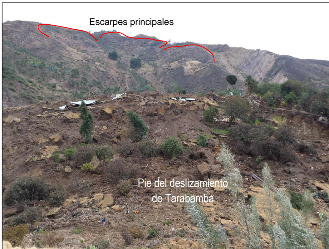
Foto 3: Vista a la parte alta, desde el cuerpo del deslizamiento de Tarabamba.
