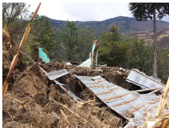
Foto 16: Centro educativo completamente destruido.
