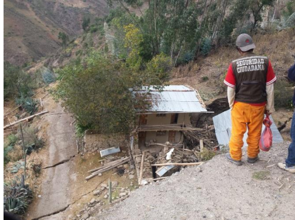
Foto 10: Colapso de 30m de una vivienda y la carretera de acceso al caserío de Tarabamba.
