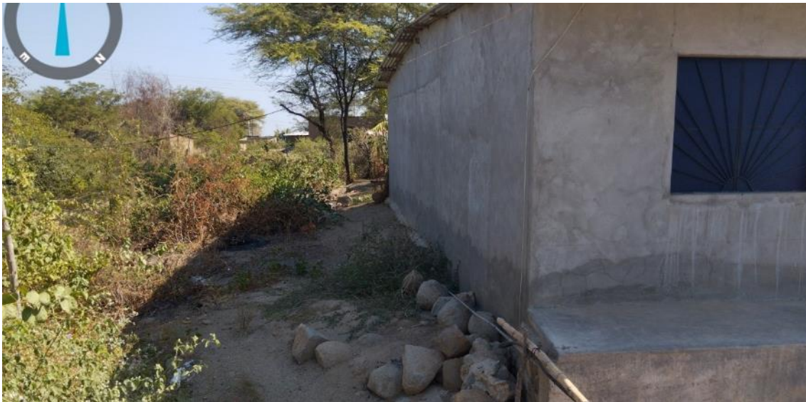
Figura 24. Vivienda afectada por inundación en el AA.HH. Las Palmeras.
