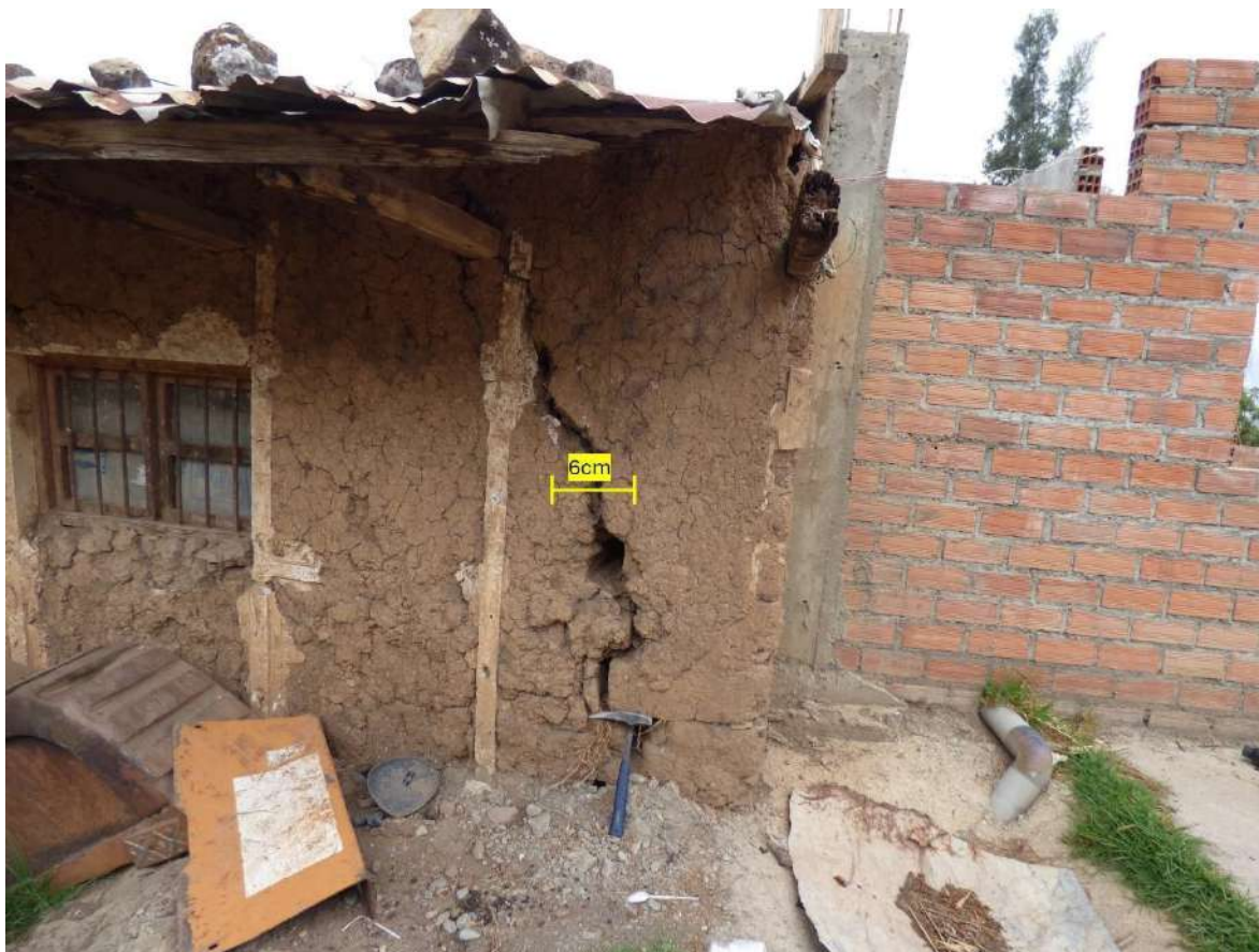
Figura 23. Vista de vivienda con paredes de adobe que se muestra agrietada. Coordenadas referenciales UTM WGS-84, 18S: E: 204734; N: 8982205.
