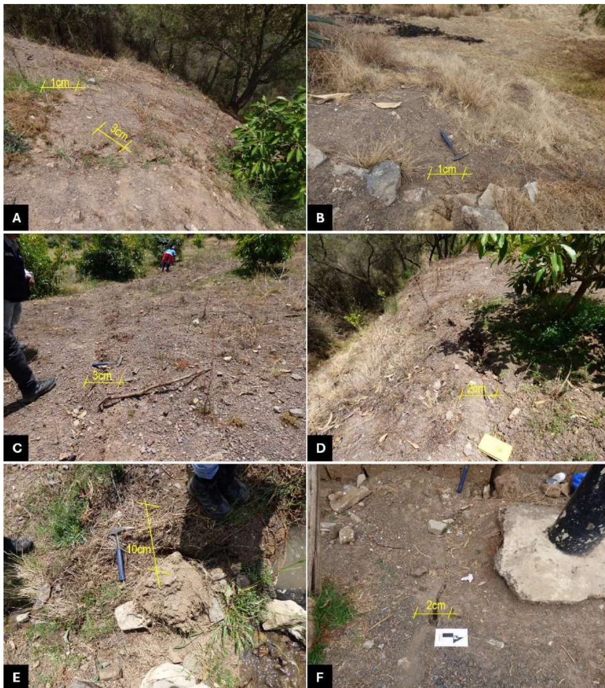
Figura 19. Grietas tensionales en el terreno, encontradas en el depósito de movimiento en masa antiguo como indicadores del proceso de reactivación, asociado al movimiento actual y que se encuentra afectando viviendas del poblado. Las grietas tienen un ancho promedio de 1-10 cm, con longitud promedio visible de 7 - 10m y profundidad visible promedio de 4cm. Estas podrían afectar viviendas. Coordenadas referenciales UTM WGS-84, 18S: A E: 502702; N: 8454482. B E: 502702; N: 8454482. C E: 502702; N: 8454482. D E: 502702; N: 8454482. E. F
