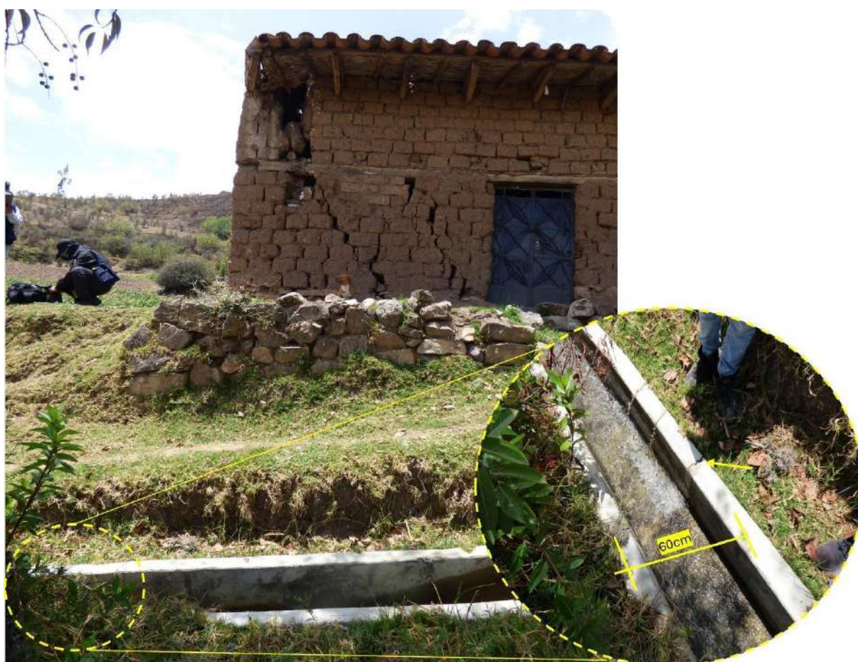
Figura 26. Vista de vivienda con paredes de adobe que se muestra agrietada y canal principal de 60cm de ancho también agrietado. Coordenadas referenciales UTM WGS-84, 18S: E: 204802; N: 8982355.
