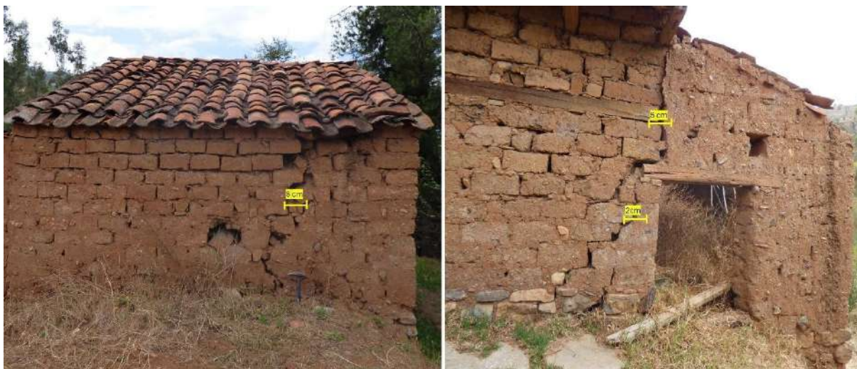
Figura 25. Vista de vivienda con paredes de adobe que se muestra agrietada. Coordenadas referenciales UTM WGS-84, 18S: E: 204111; N: 8982059 (izquierda); E: 205093; N: 8982035 (derecha).
