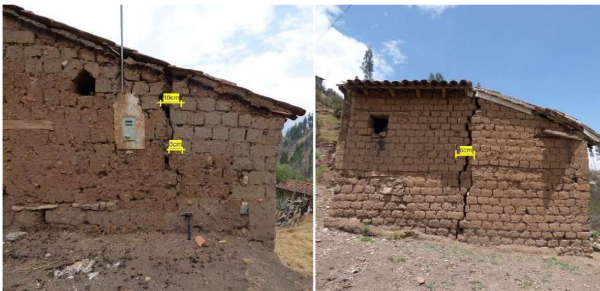
Figura 24. Vista de vivienda con paredes de adobe que se muestra agrietada. Coordenadas referenciales UTM WGS-84, 18S: E: 204884; N: 8982128 (izquierda); E: 204802; N: 8982355 (derecha).
