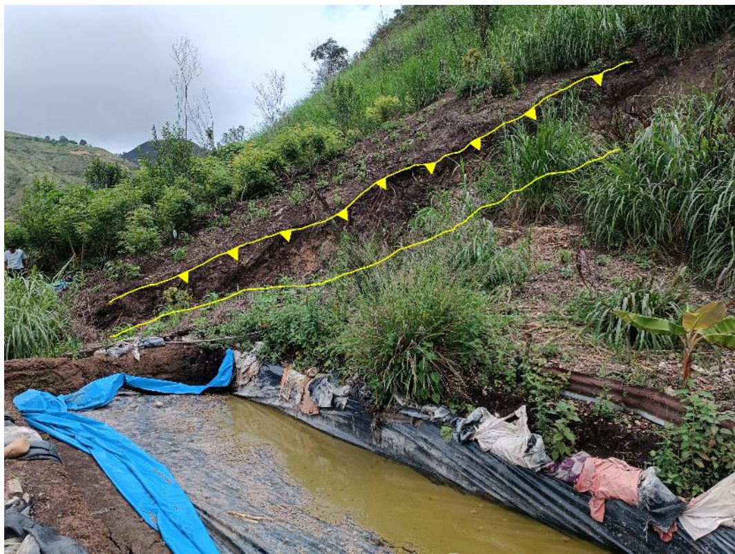
Figura 12. Salto vertical deslizamiento activo – DA1 y reservorio artesanal en mal estado. Coordenadas UTM WGS84 17M. 771038, 9323389.
