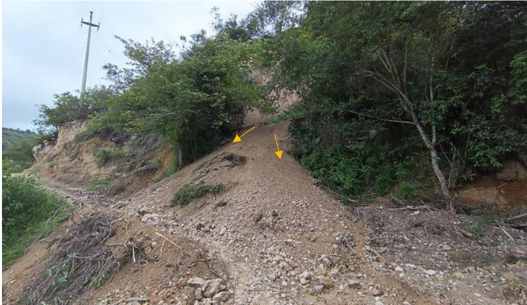
Figura 15. Material deslizado en dirección de la vía CA-799 – Cunuat Coordenadas UTM WGS84 17M. 771073, 9323414.
