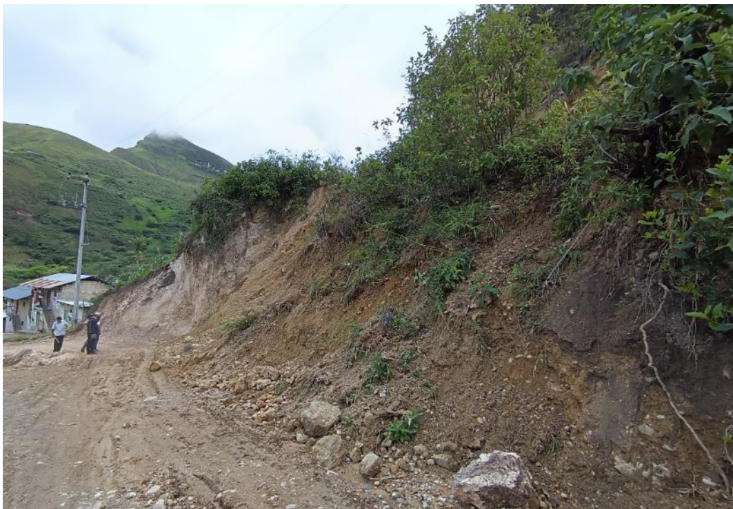
Fotografía 2. Vista de vertiente de depósito de deslizamiento (V-dd), en el caserío de Cunuat.
