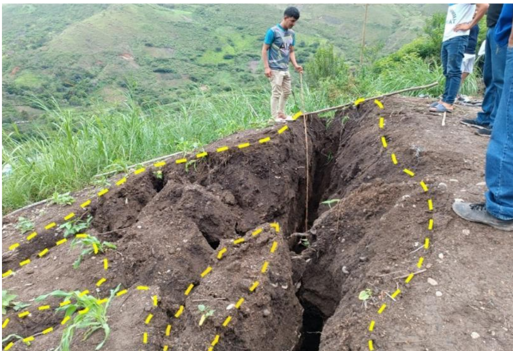
Figura 14. Agrietamiento en el deslizamiento activo – DA1. Coordenadas UTM WGS84 17M. 770986, 9323390.
