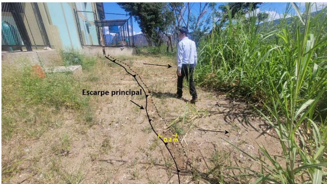
Figura 12. En la figura se muestra el agrietamiento originado en el escarpe principal rellenado superficialmente.
