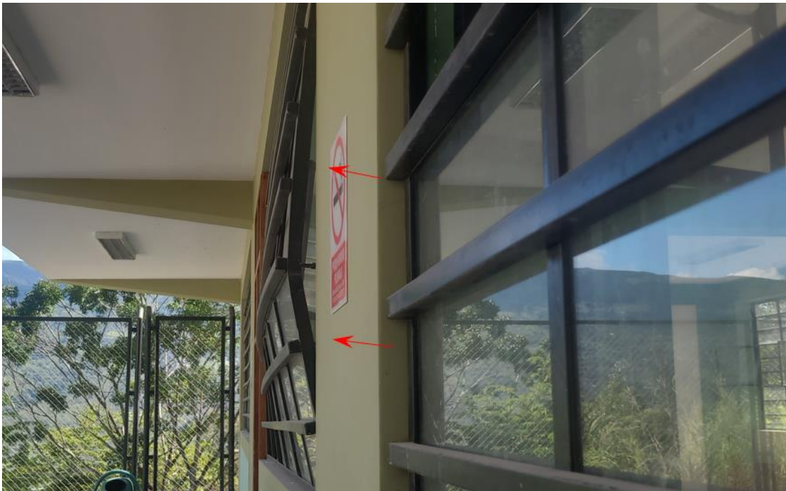
Figura 29. El asentamiento de la infraestructura, origina la deformación (pandeo) de las ventanas y el deterioro de los vidrios. Coordenadas WGS 84 – 17s: 785208E, 9325032N.
