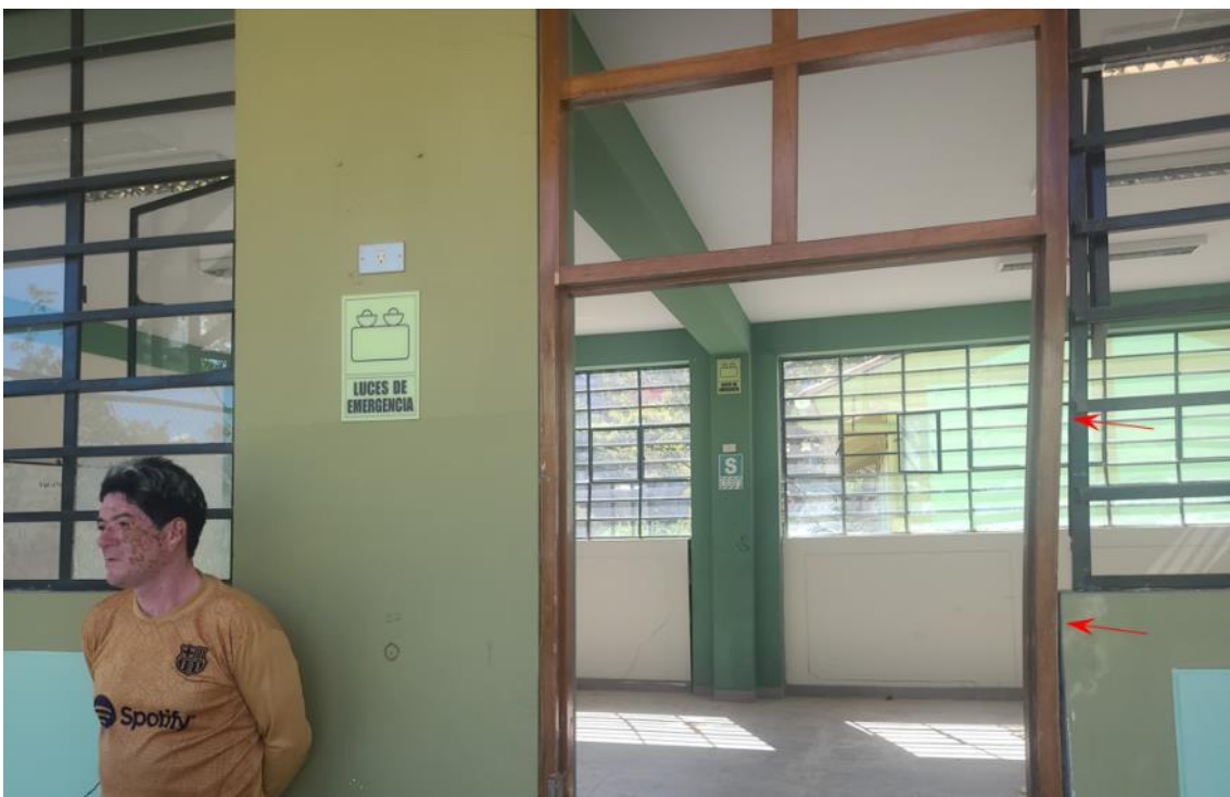
Figura 30. Puertas descuadradas por el asentamiento de la infraestructura. Coordenadas WGS 84 – 17s: 785204E, 9325038N.
