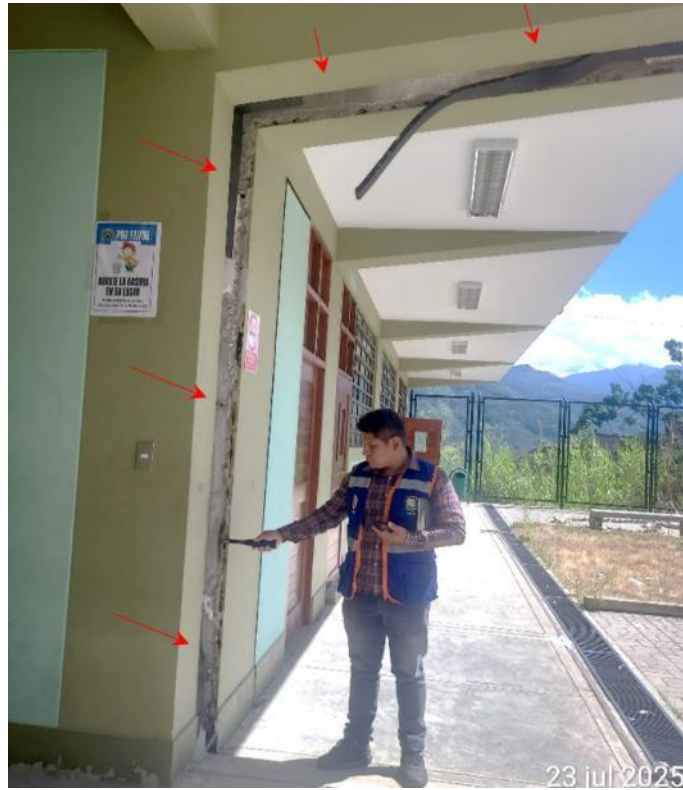
Figura 23. Separación en las columnas en ambientes de la institución educativa. Coordenadas WGS 84 – 17s: 785120E, 9325027N.
