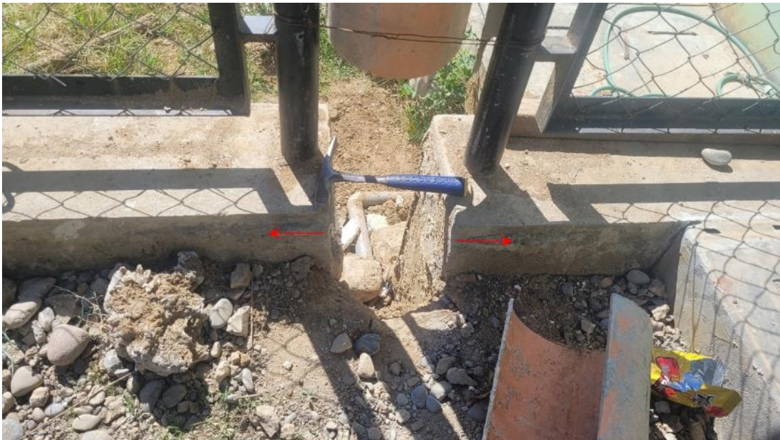
Figura 17. Se observa separación en paneles de malla metálica del cerco perimétrico, durante la construcción la separación es de 10 cm, actualmente tiene 32 cm. Coordenadas WGS 84 – 17s: 785181E, 9325040N
