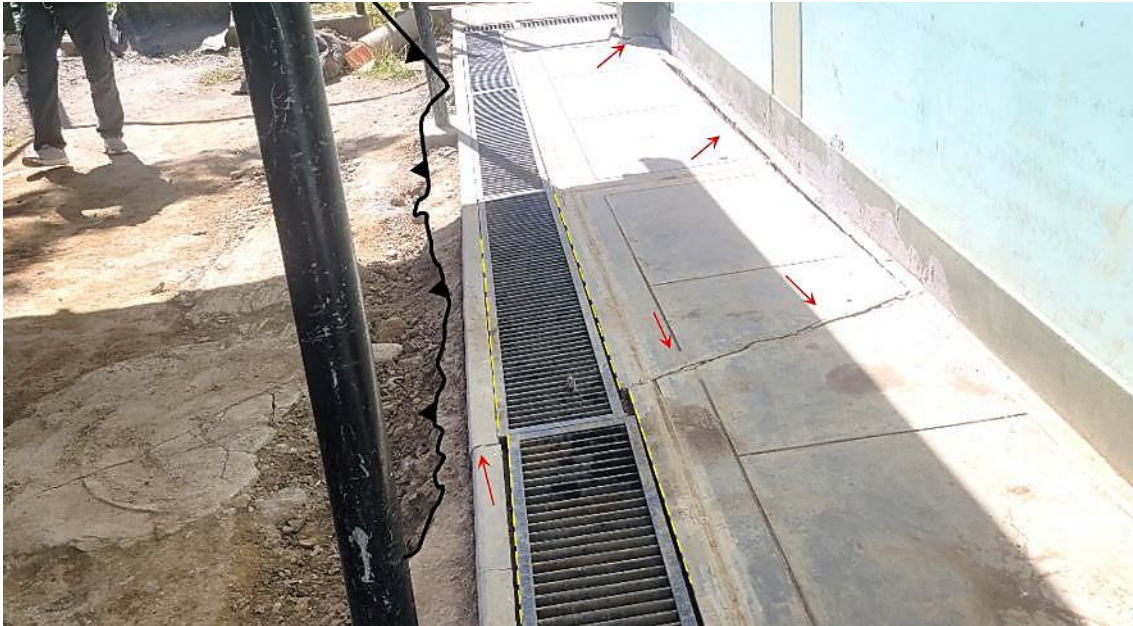
Figura 15. Agrietamiento transversal, en la parte posterior al escarpe principal, afecta vereda y cuneta de drenaje de la institución educativa. Coordenadas WGS 84 – 17s: 785180E, 9325040N.
