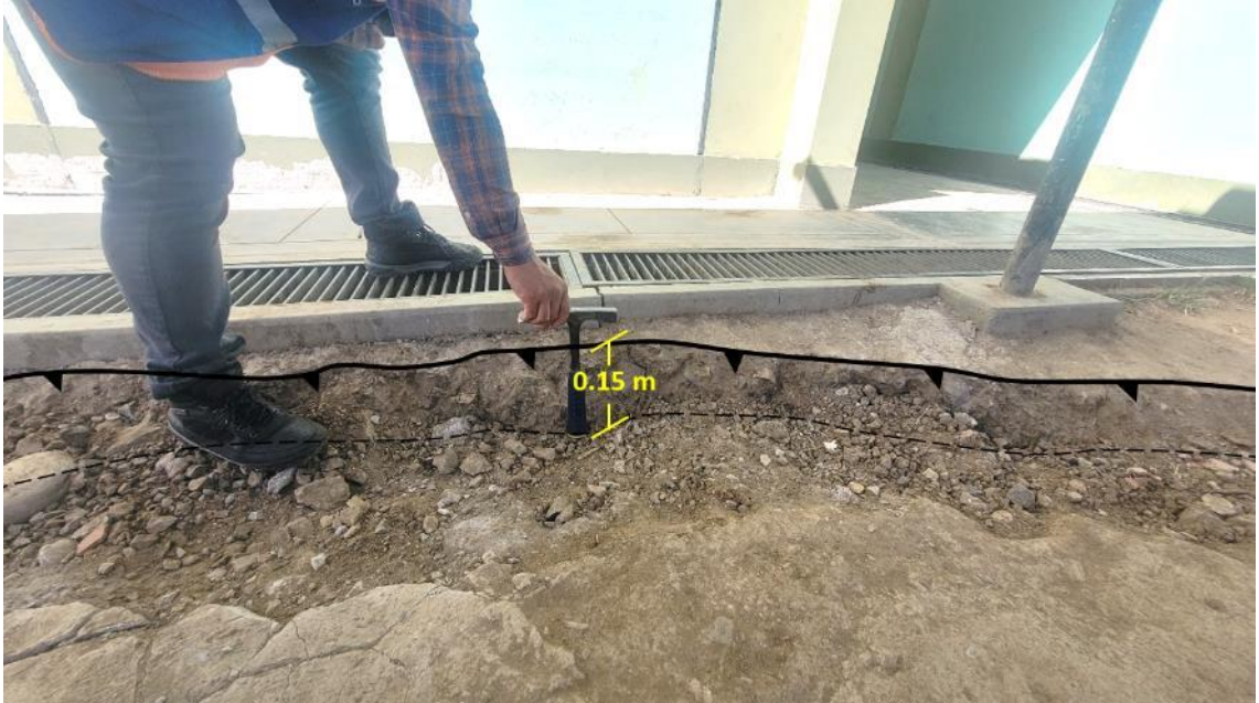
Figura 14. Se observa el escarpe principal, el cual está iniciando con un desnivel vertical de 0.15 m.
