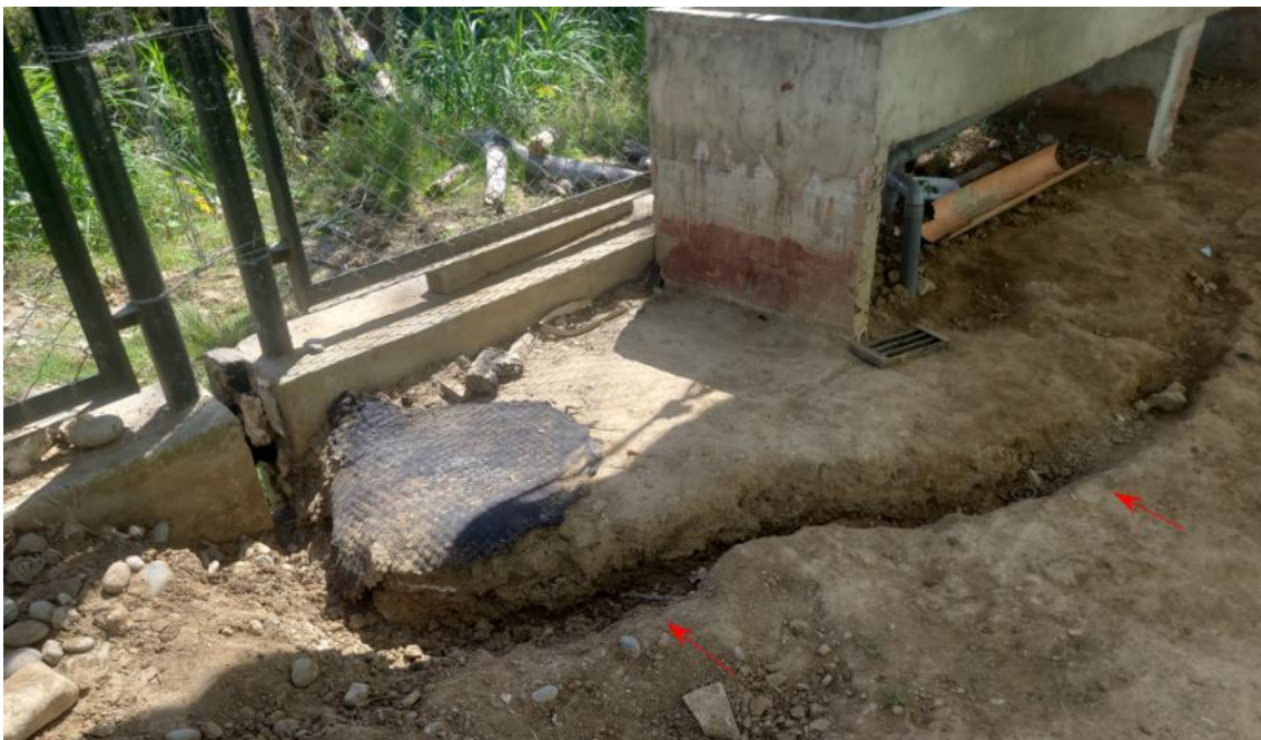
Figura 18. Se observa separación en paneles de malla metálica del cerco perimétrico, y grieta en el terreno. Coordenadas WGS 84 – 17s: 785171E, 9325034N.
