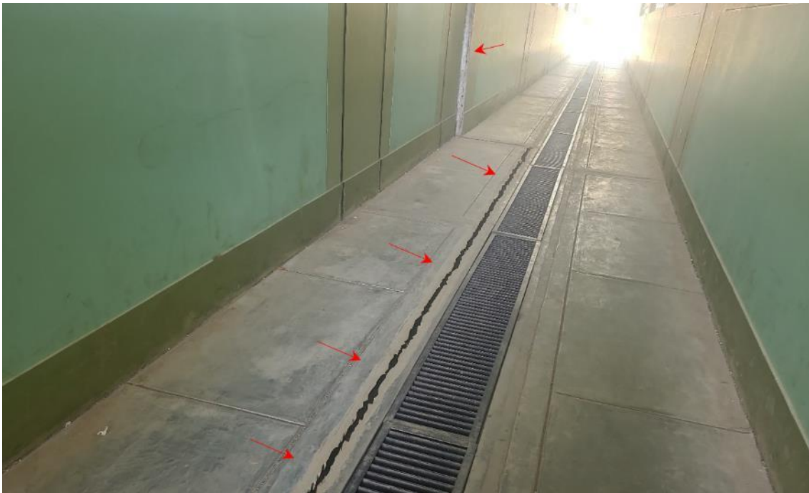
Figura 21. Agrietamiento paralelo a la cuneta de drenaje y separación lateral de pared. Coordenadas WGS 84 – 17s: 785180E, 9325032N.
