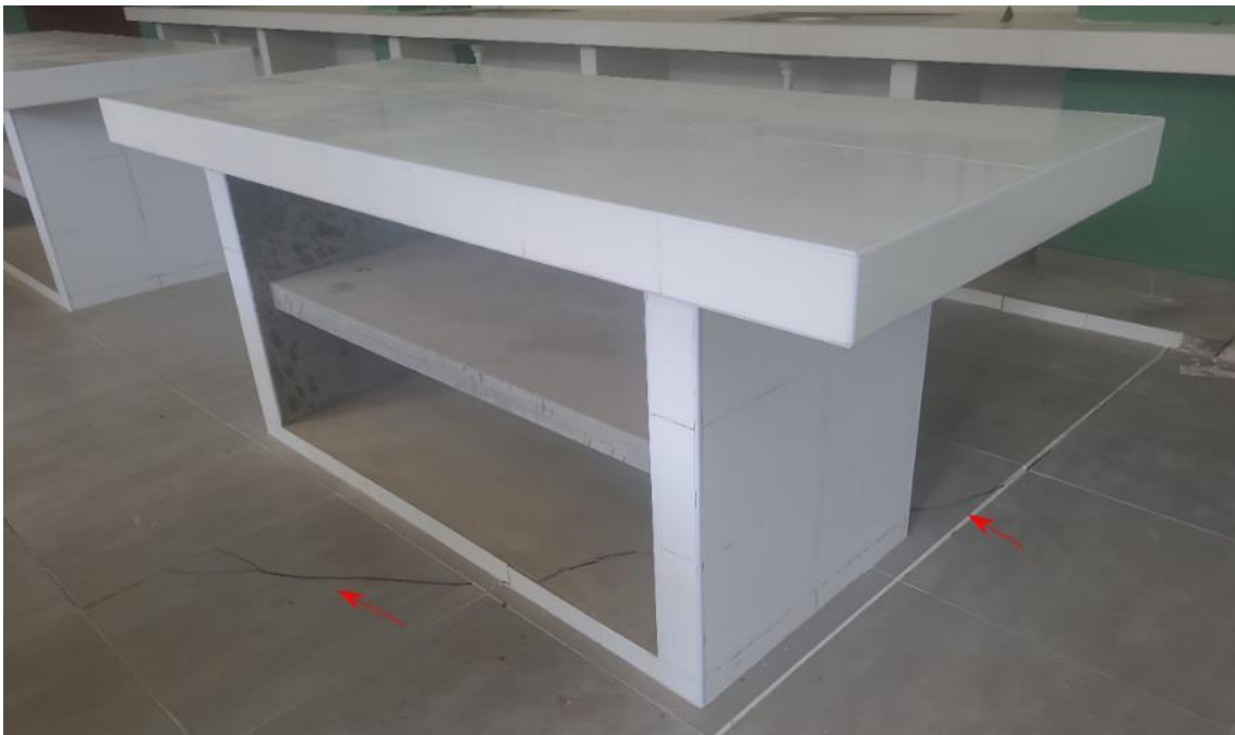
Figura 32. Agrietamiento en piso de laboratorio. Coordenadas WGS 84 – 17s: 785186E, 9325032N.
