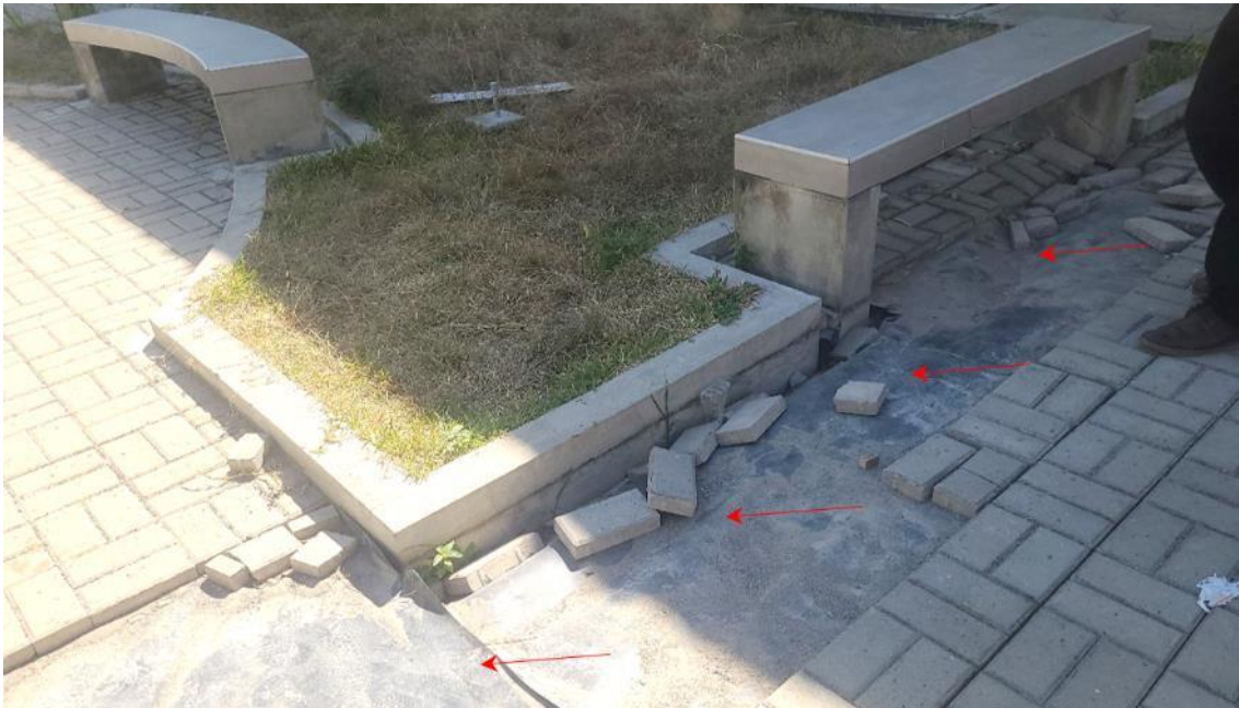
Figura 25. En el patio principal se puede observar agrietamiento y asentamiento del terreno que ha originado el deterioro del embroquetado. Coordenadas WGS 84 – 17s: 785202E, 9325029N.
