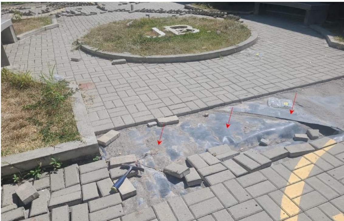
Figura 24. En el patio principal se puede observar agrietamiento y asentamiento del terreno que ha originado el deterioro del emboquetado.
