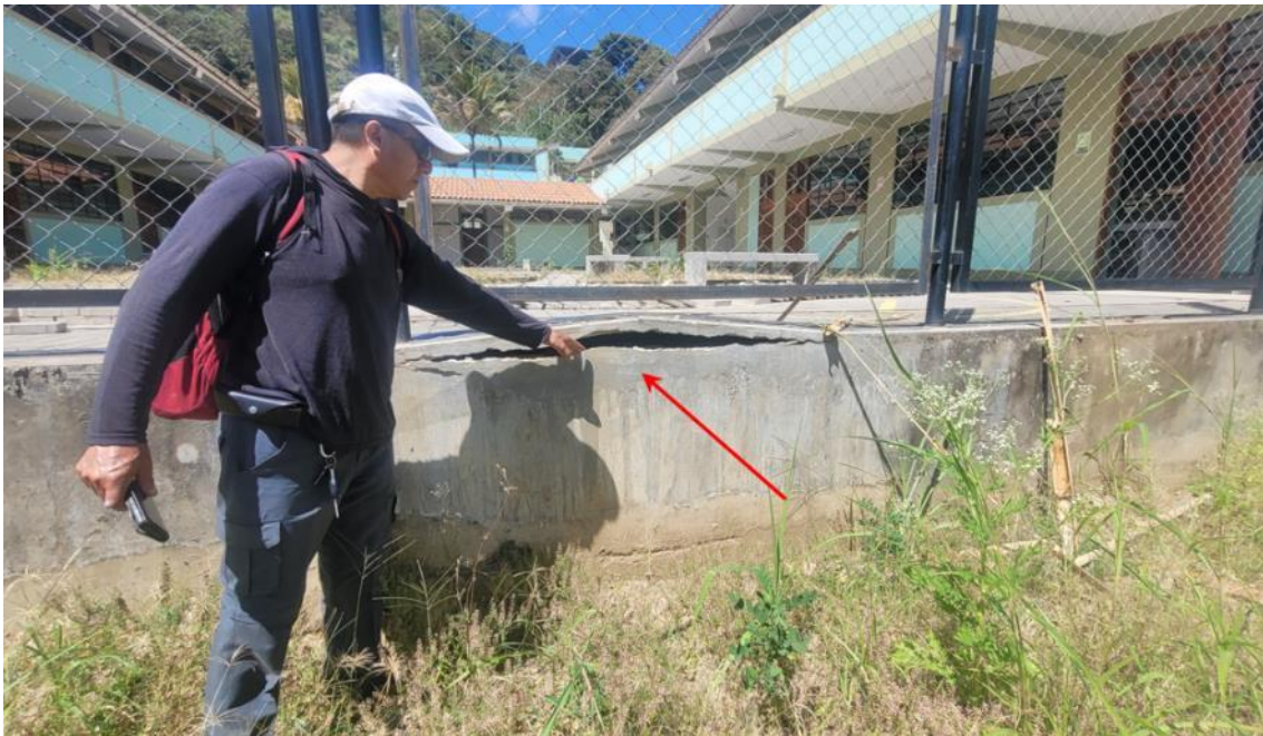
Figura 19. Deterioro por levantamiento de vereda, en el cerco perimétrico. Coordenadas WGS 84 – 17s: 785181E, 9325040N.
