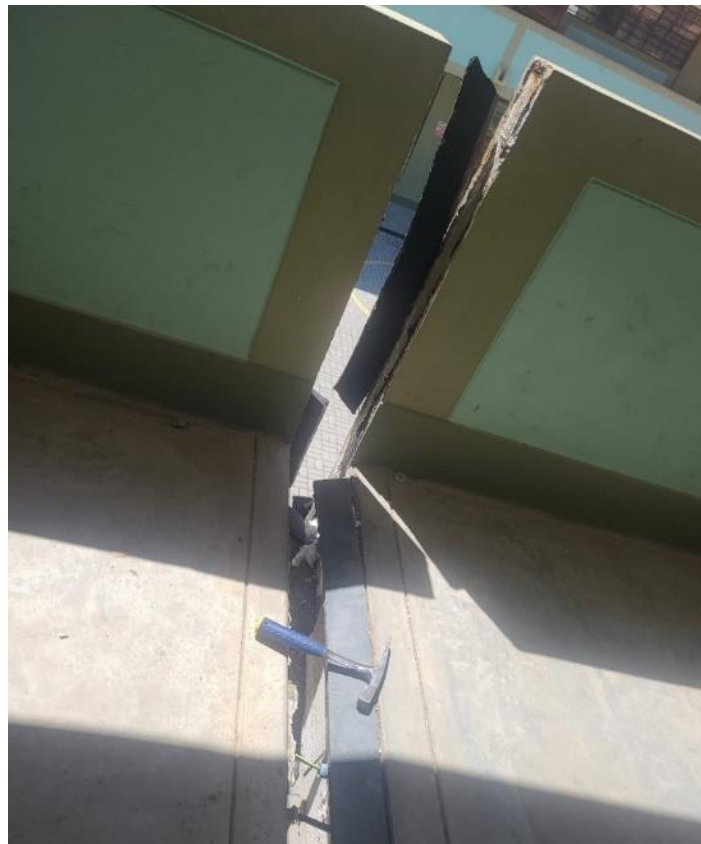
Figura 26. Separación en juntas de dilatación del pasadizo del segundo piso. Coordenadas WGS 84 – 17s: 785194E, 9325022N.
