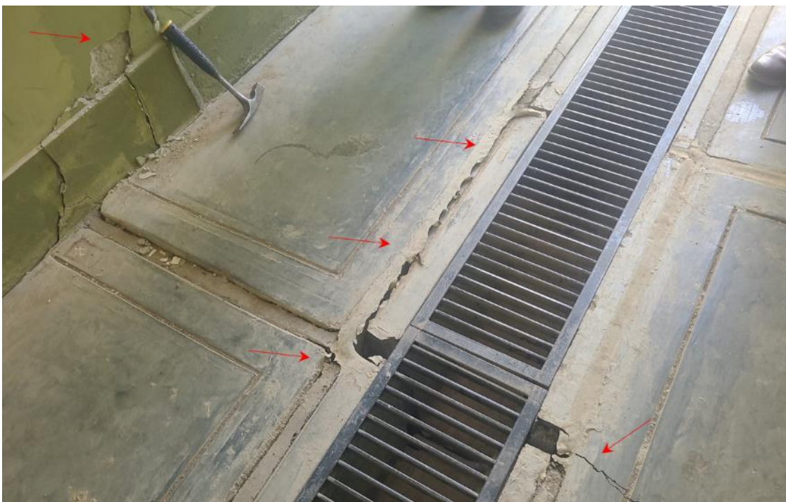
Figura 20. Agrietamientos en pared y pisos de pasadizo, se observa que fueron reparadas, y se vuelven a separar, afectando cuneta de drenaje Coordenadas WGS 84 – 17s: 785180E, 9325032N.
