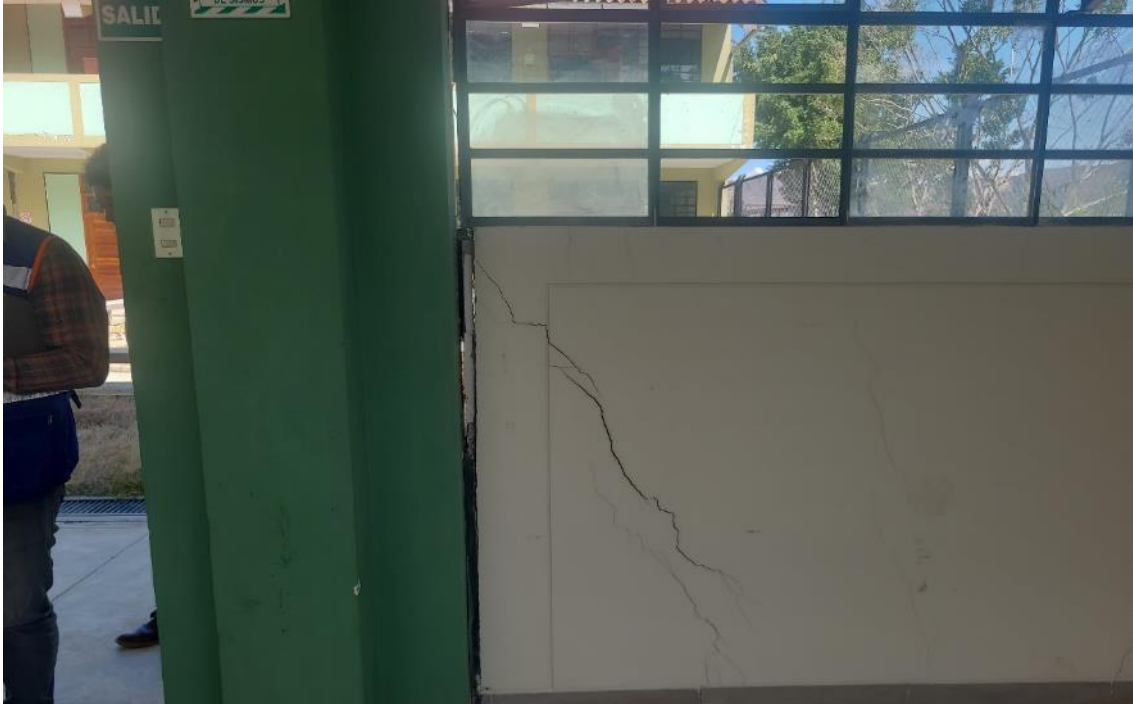
Figura 31. Agrietamiento en pared y separación de columna, en ambiente de la biblioteca. Coordenadas WGS 84 – 17s: 785210E, 9325038N.
