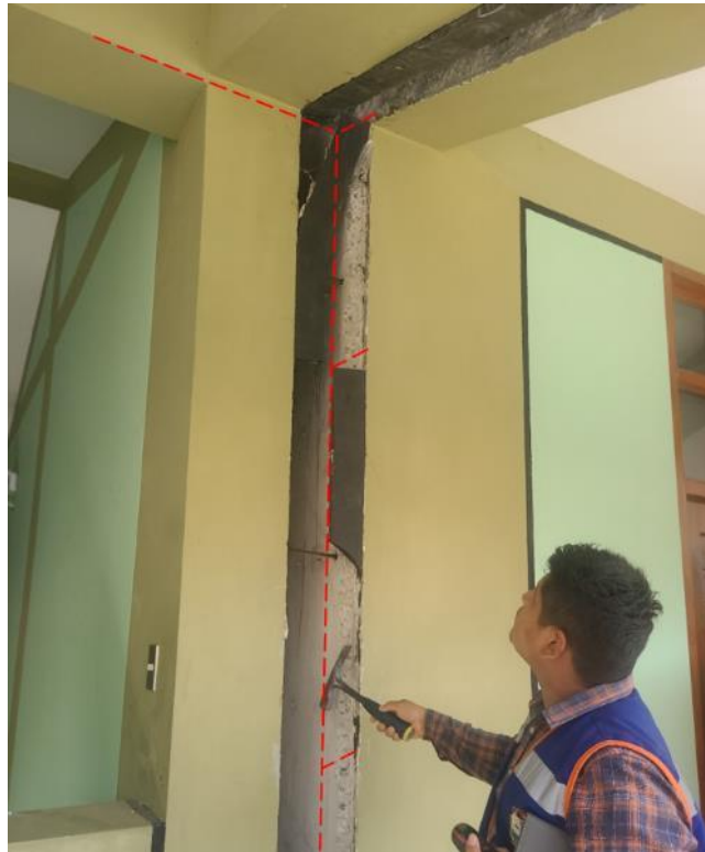
Figura 27. Separación en columnas y vigas del techo del segundo piso. Coordenadas WGS 84 – 17s: 785193E, 9325021N.
