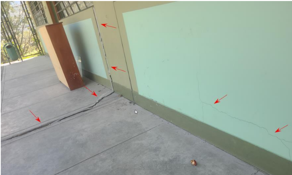
Figura 28. Se observa agrietamientos en pisos y paredes exteriores de la biblioteca. Coordenadas WGS 84 – 17s: 785208E, 9325032N.
