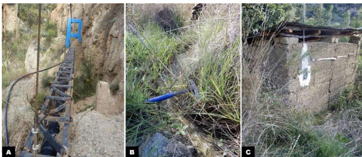
Figura 23. A. Canal con puente aéreo. B. Curso de agua reciente. C. Vivienda afectada por la filtración de agua.
