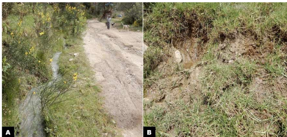
Figura 21. A. Canal principal sin revestimiento, se observa humedad en el camino B. Terreno con alto contenido de humedad.
