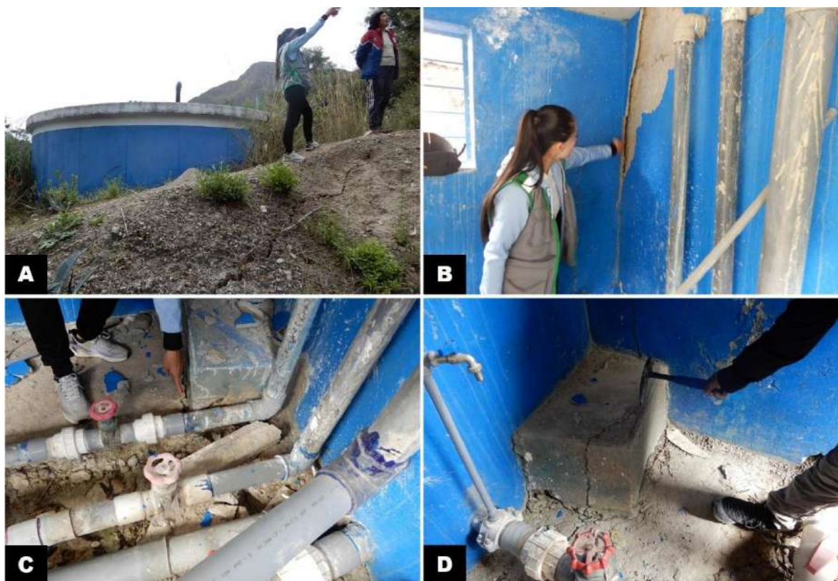
Figura 27. Reservorio principal afectado, se observan grietas en toda su estructura.
