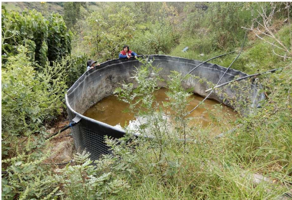
Fotografía 2. Reservorio de captación que recoge agua del subsuelo mediante tuberías de HDPE.
