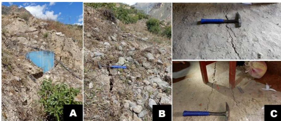
Figura 26. A. Reservorio afectado, se observan grietas en su base. B. Grieta paralela al escarpe principal. C. Grietas en el suelo de vivienda.
