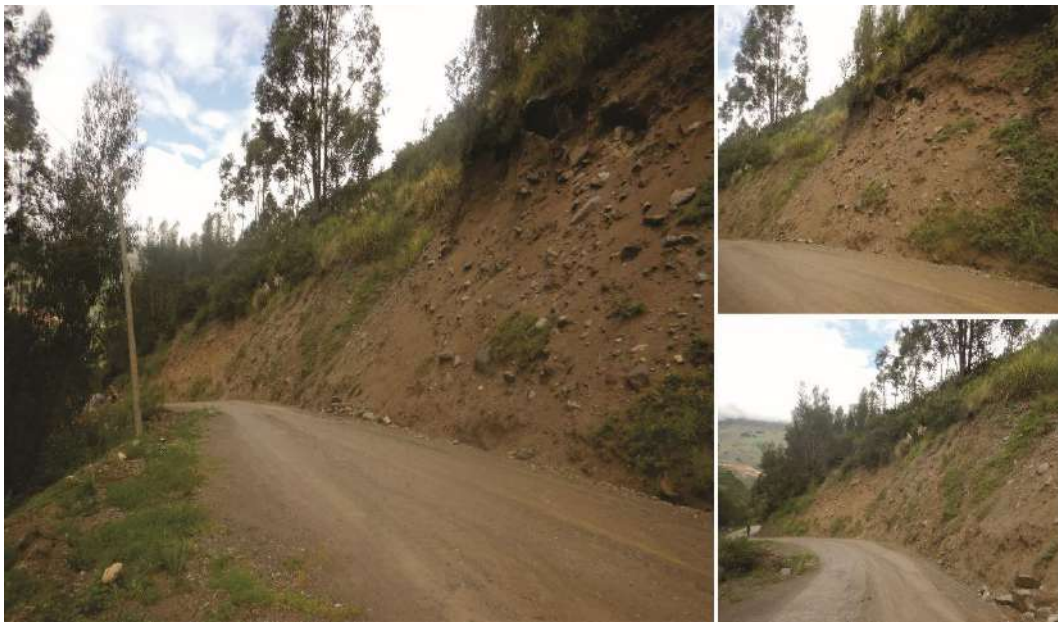
Figura 19. Derrumbes antiguos que tienen reactivaciones en temporada de lluvias.
