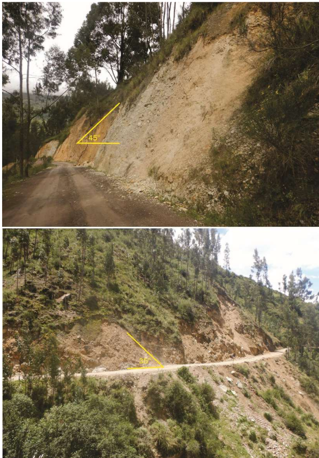
Figura 10. Vista de la inclinación de las laderas colindantes entre la vía de San Pedro - Huallicor, donde se muestra pendientes muy fuertes a muy escarpadas ( 55^\circ - >45^\circ ).
