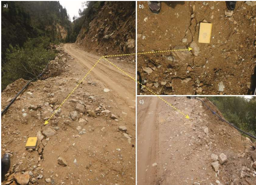
Figura 21. Presencia de grietas transversales en la vía, las cuales fueron selladas hace meses atrás; sin embargo, actualmente están reapareciendo.
