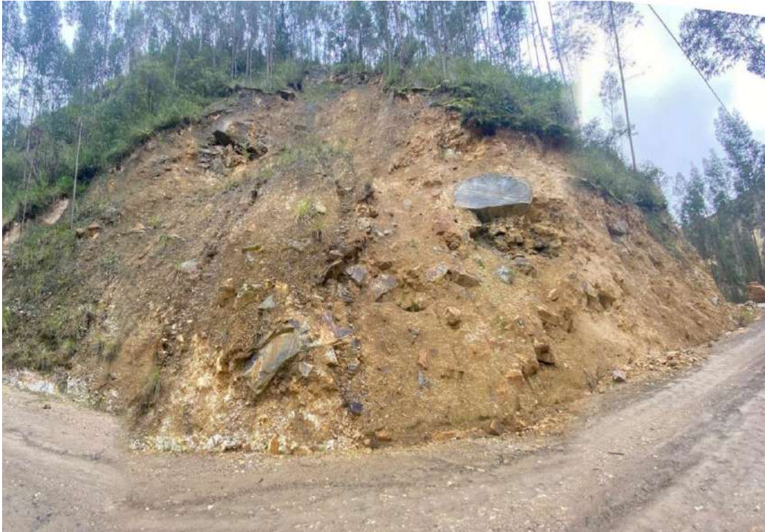
Fotografía 2. Derrumbe (D1) en la vía de Hualcor – San Pedro, se observan bloques colgados en la ladera; así mismo el material que cae está obstruyendo la cuneta ubicada a un lado de la vía.
