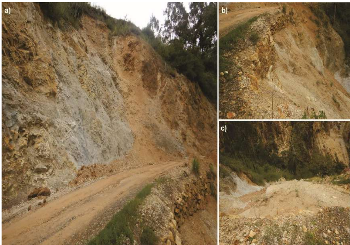
Figura 18. Tramo de la vía presenta derrumbes antiguos, donde se visualiza destrucción de 15 m de la vía.
