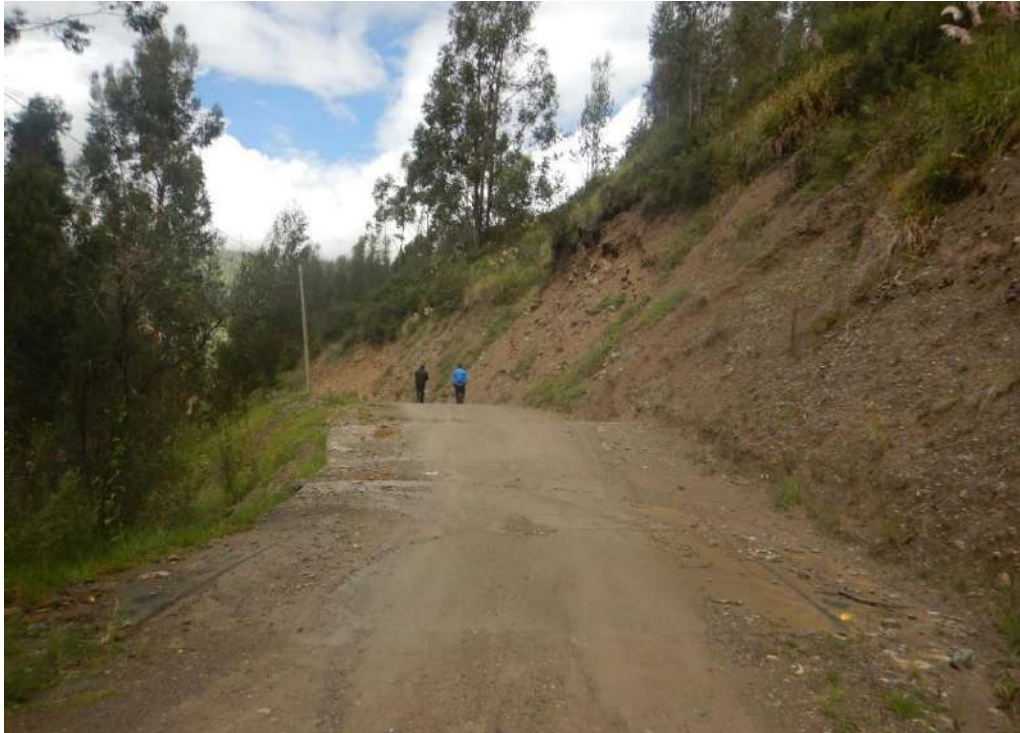
Fotografía 3. Sector afectado por derrumbes continuos ocurridos el 2021, actualmente se evidencia un baden, en un tramo de la vía. Esta se ubica entre las coordenadas UTM 8937806 N, 225783 E.
