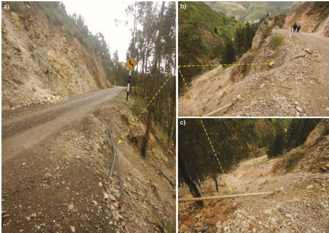
Figura 17. Tuberías de agua potable afectadas por los derrumbes, estas se ubican entre las coordenadas UTM 8937389 N, 225330 E.
