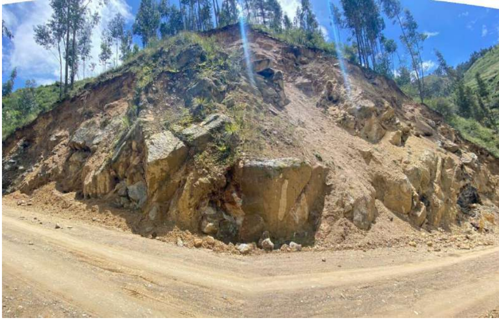
Fotografía 4. Vista frontal del derrumbe con dirección al norte, reactivado el 6 de marzo del 2025.
