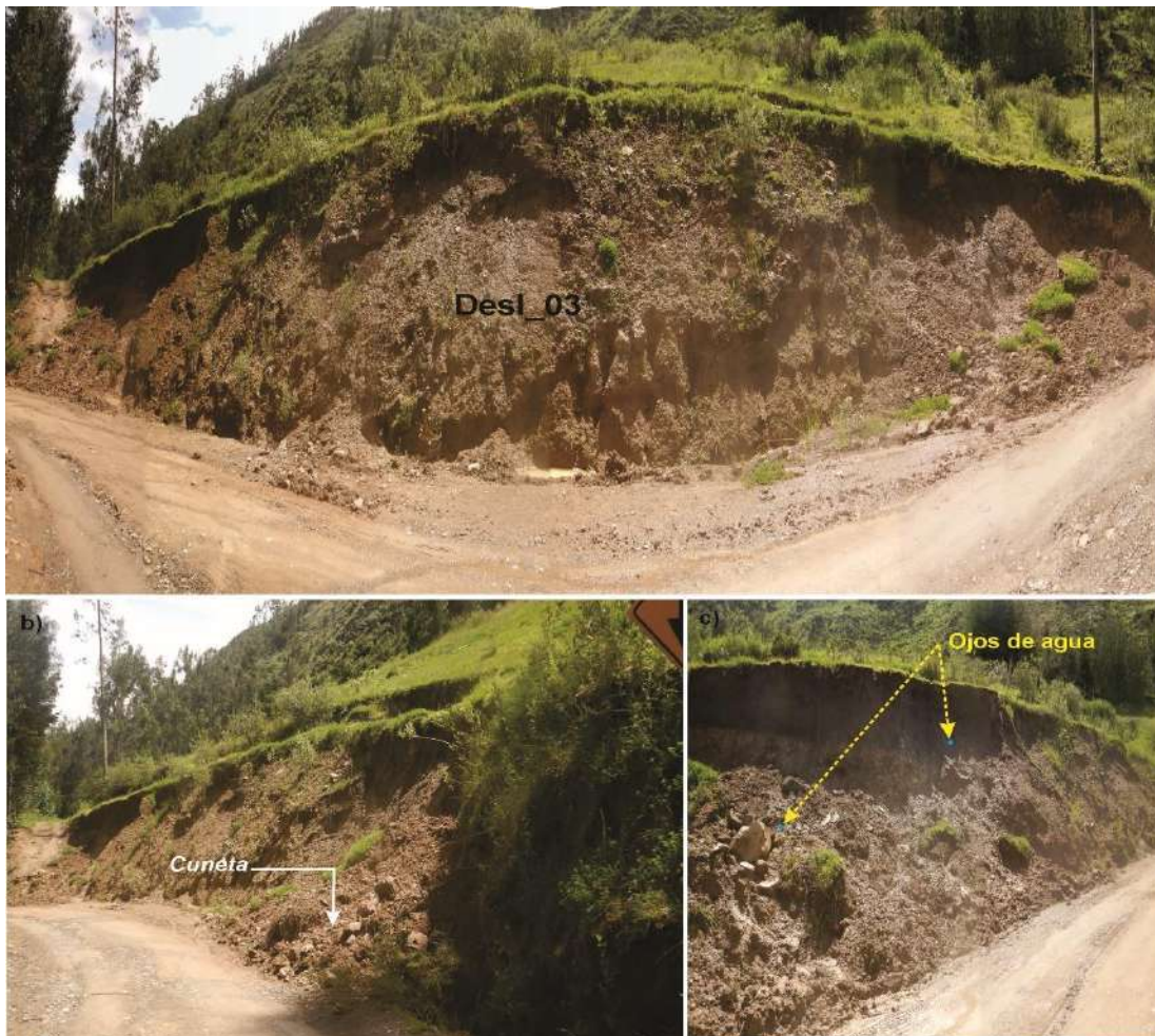
Figura 25. El deslizamiento recientemente activado, esta afectando la cuneta y presenta emanación de aguas subterráneas en dos puntos del cuerpo del deslizamiento.
