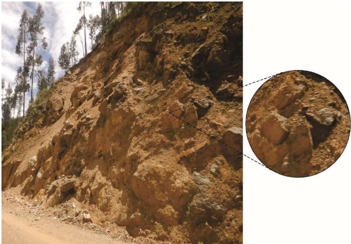
Figura 8. Vista de depósito coluvial, con pendiente mayores a 30°, ubicadas a un lado de la vía.
