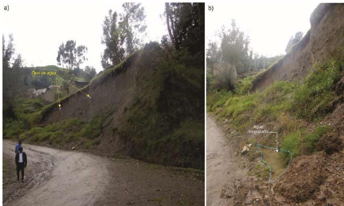
Figura 23. Se observa emanación de agua subterránea, del cuerpo del deslizamiento, el cual esta siendo empozada al pie de la misma.
