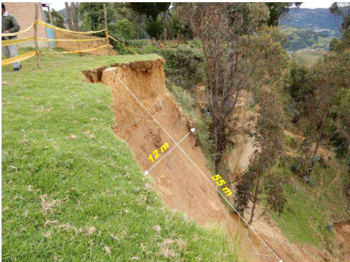
Figura 18. Vista hacia el noreste del derrumbe producido el presente año en ladera de pendiente que varía de fuerte a muy fuerte.
