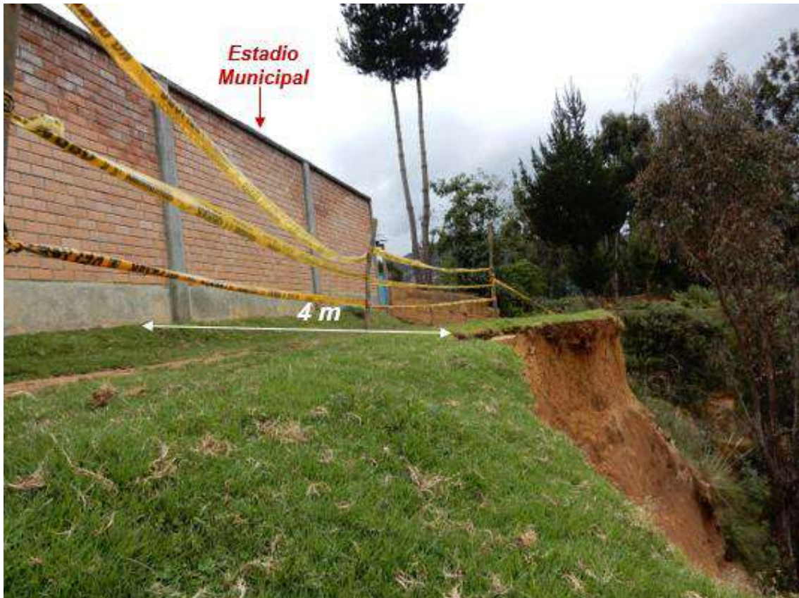
Figura 19. Vista del estadio Municipal de Sillapata, ubicado a 4 m del derrumbe producido el presente año.
