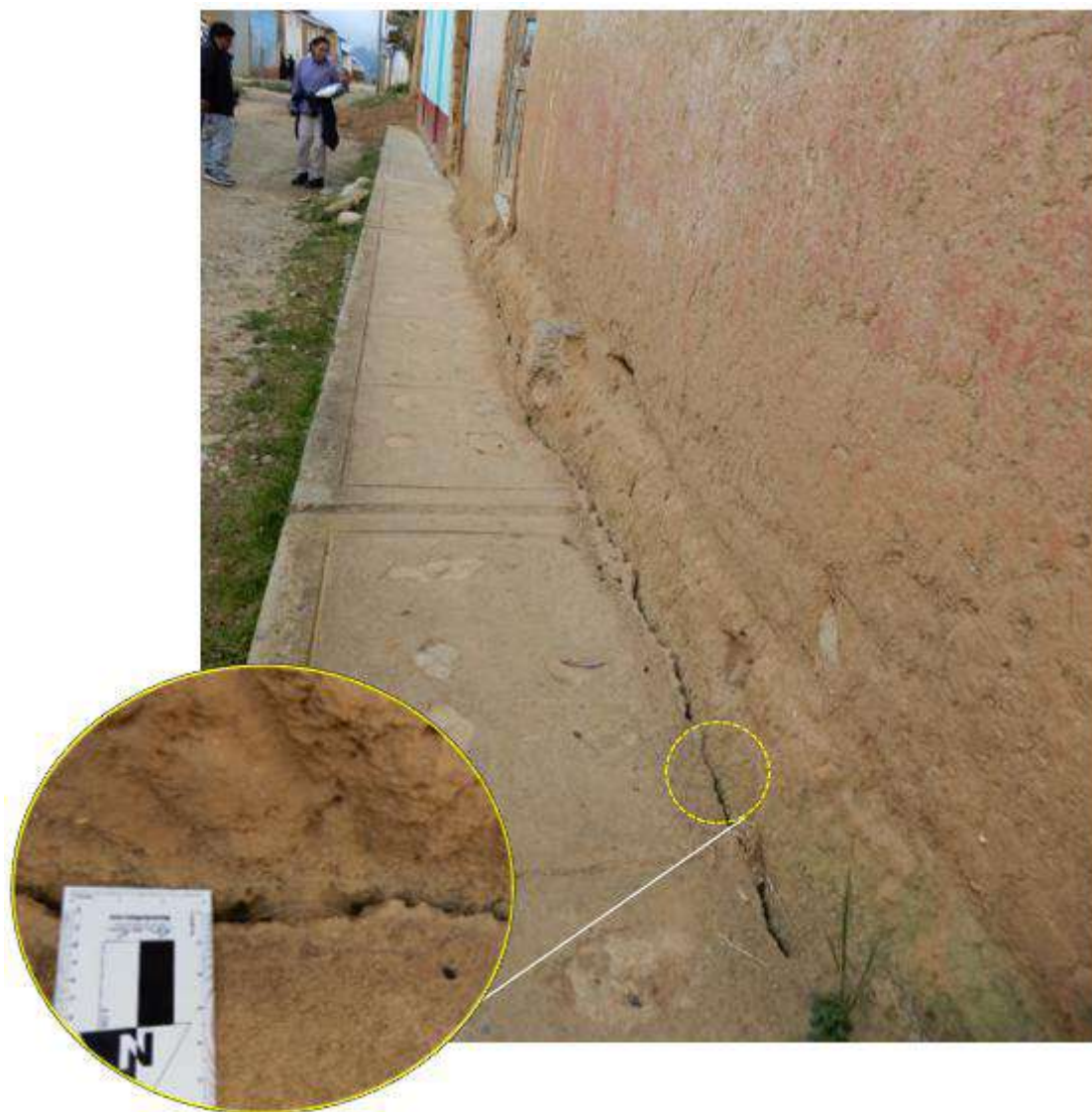
Figura 17. Agrietamiento que separa la vereda de la vivienda, producida hace aproximadamente 2 años.
