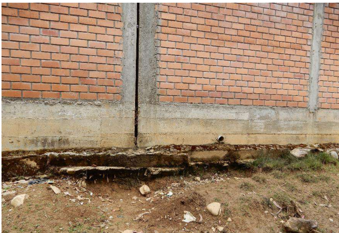
Fotografía 10. Tubería de drenaje de la I.E. N° 32250, que vierte sus aguas hacia la ladera oeste de Sillapata.
