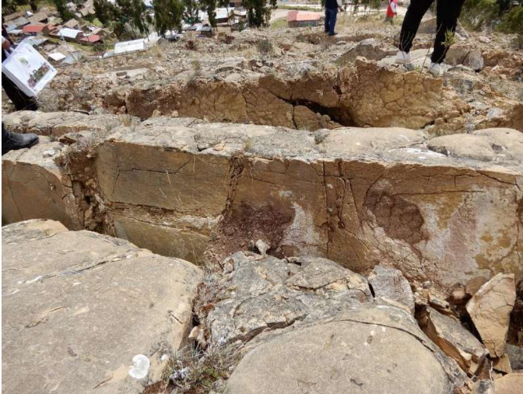
Fotografía 4. Deformación interna del macizo rocoso, que afecto parte de la ladera noroeste del cerro Pucará.
