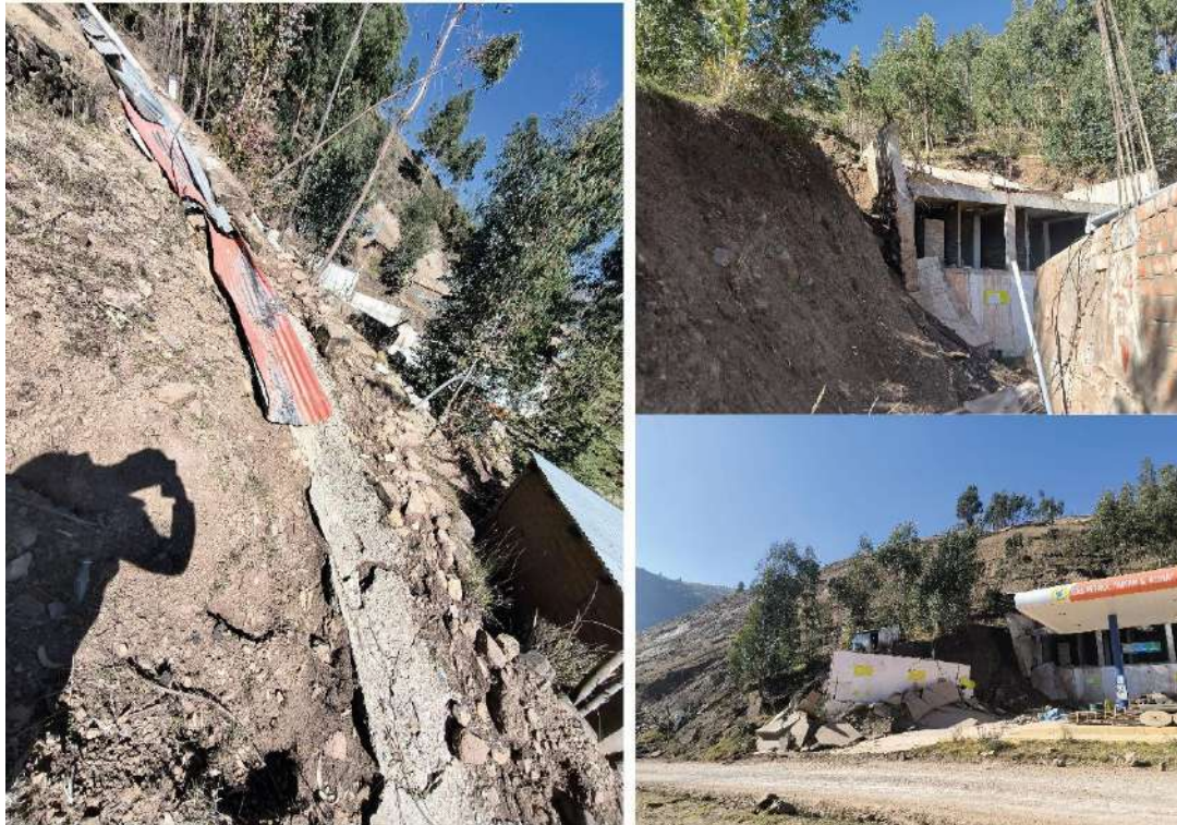
Figura 11. De izquierda a derecha se observa parte del encauzamiento de una quebrada de corto recorrido, así como la afectación directa al grifo ubicado en la base del talud, producto de los procesos de deslizamiento desarrollados en la ladera del cerro.
