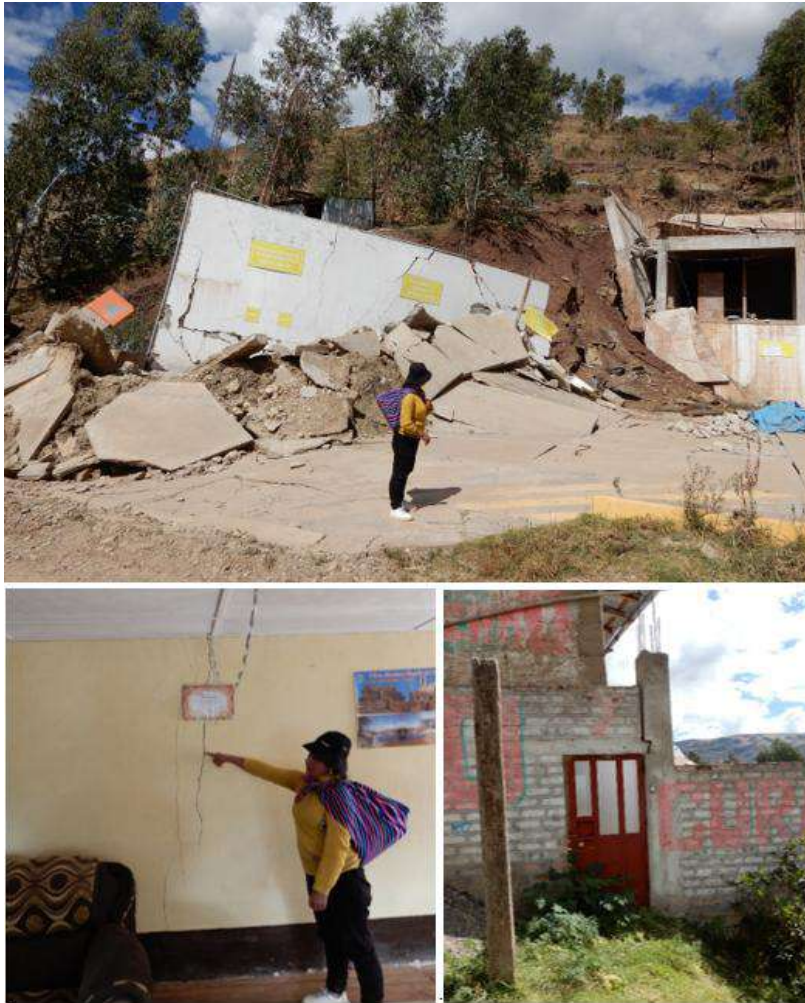
Figura 11. Vista de las aperturas y profundidad de las grietas producidas en la ladera del cerro Pucará.
