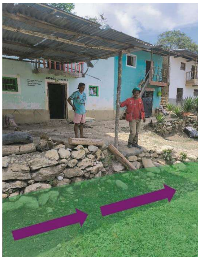
Figura 28. Viviendas expuestas a procesos de cárcava (verde) flujos (flechas moradas) e inundación en temporada de lluvias. Coordenadas referenciales UTM WGS-84, 18S: E: 764151; N: 9348741.
