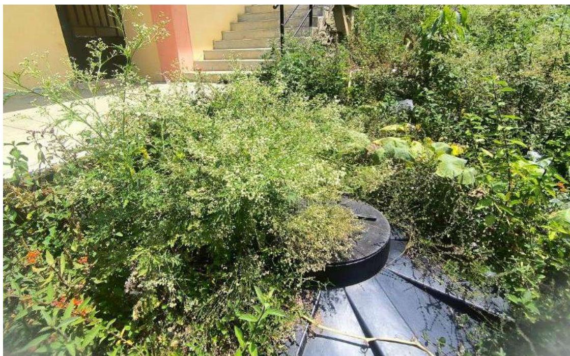
Figura 24. Biodigestor, existen alrededor de cuarenta distribuidos en las viviendas, estos se colapsan en temporada de lluvias. Coordenadas UTM WGS-84, 18S: E: 764244; N: 9348720.
