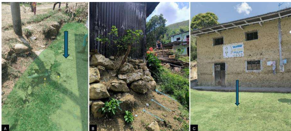
Figura 27. Vista de viviendas se resaltan (con flechas) los puntos por donde ocurre la filtración de agua y posterior inundación. Coordenadas referenciales UTM WGS-84, 18S: E:764133; N:9348747.
