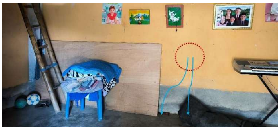
Figura 26. Vista del interior de vivienda se resalta el punto por donde ocurre la filtración de agua, esta pared es colindante con la ladera. Coordenadas referenciales UTM WGS-84, 18S: E: 764151; N: 9348741.
