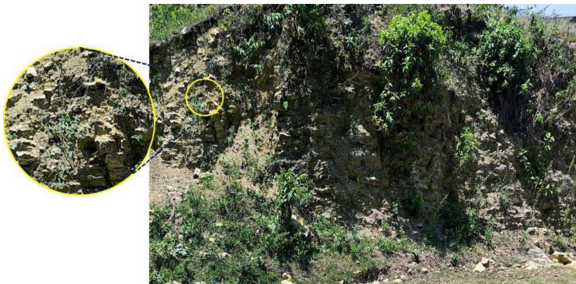
Figura 8. Vista del depósito coluviodeluvial conformado por clastos subredondeados a subangulosos heterométricos con tamaños que van de 0.2- 50 cm. envueltos en una matriz arcillo-limosa, el depósito se muestra húmedo. Coordenadas UTM 18S 764326E; 9348760N.
