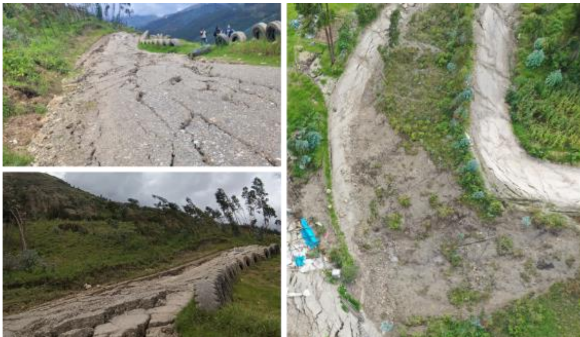
Figura 18. Se observa los tramos de las vías afectadas.
