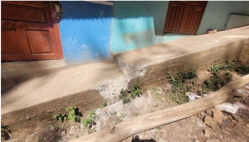
Figura 7. Acera afectada por bloque de 1m.
