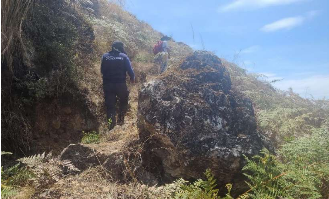
Fotografía 9. Bloque R5, sobre ladera con pendiente >30^\circ , se puede observar que no tiene medida de control ante probable caída. Ubicación: E 741097 y N 9213365.
