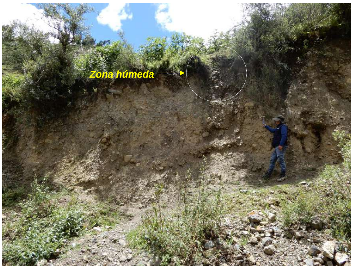
Figura 11. Vista de zonas húmedas en el cuerpo del deslizamiento inactivo latente.
