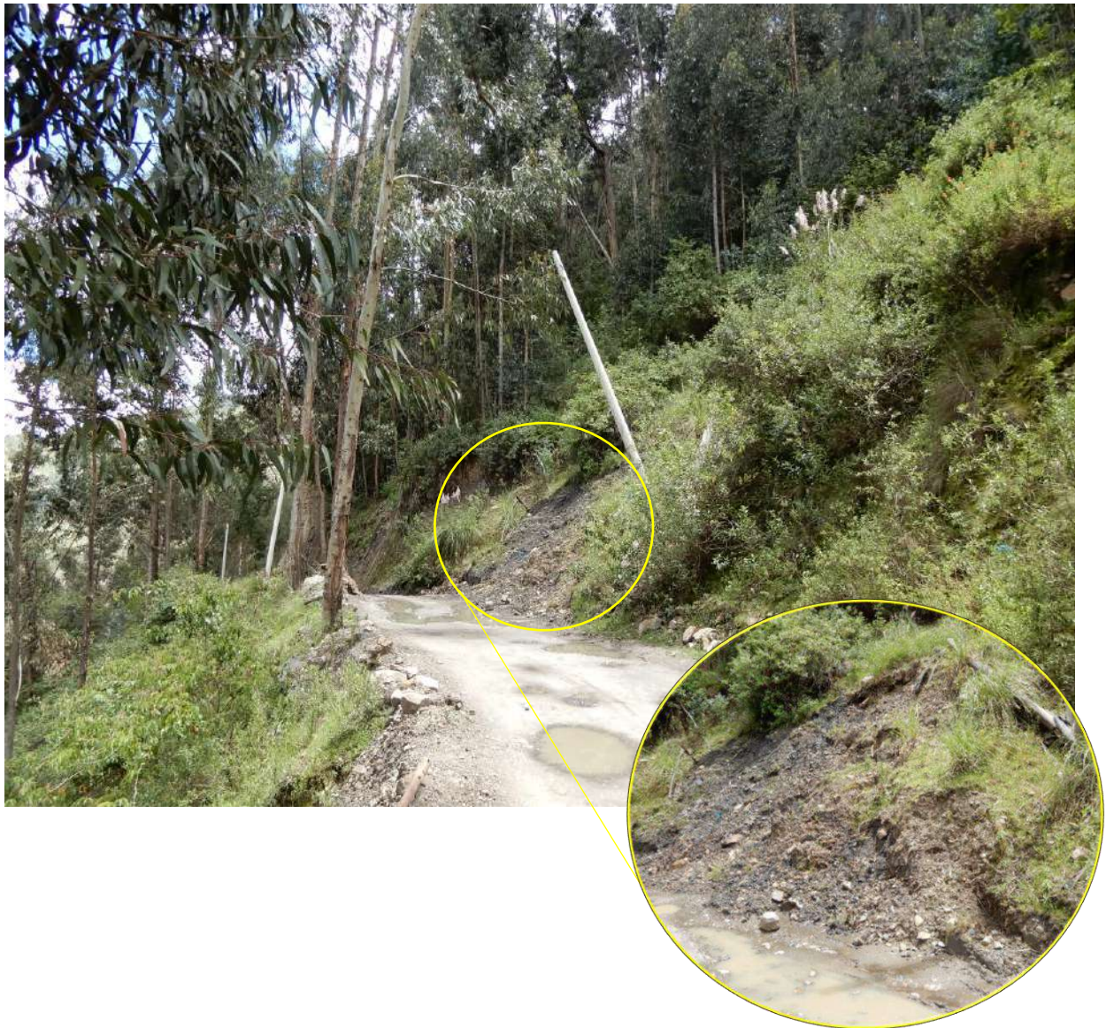
Figura 10. Vista de derrumbe, producido en el corte de talud (trocha carrozable que conduce a Chavin de Huántar).
