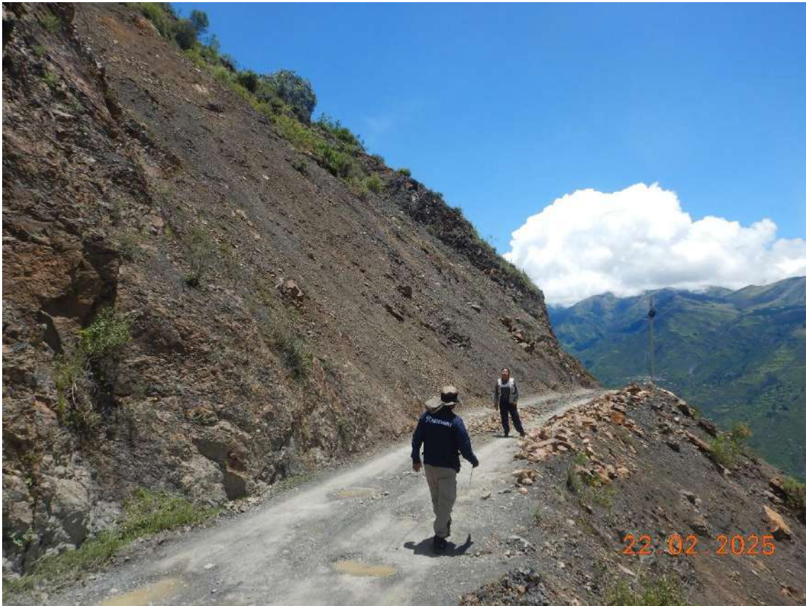
Fotografía 19: Derrumbe activo, ubicado en la vía vecinal Chanta-Pocohuanca (Prog. 11+240), que afecta recurrentemente un tramo aproximado de 40 m lineales.
