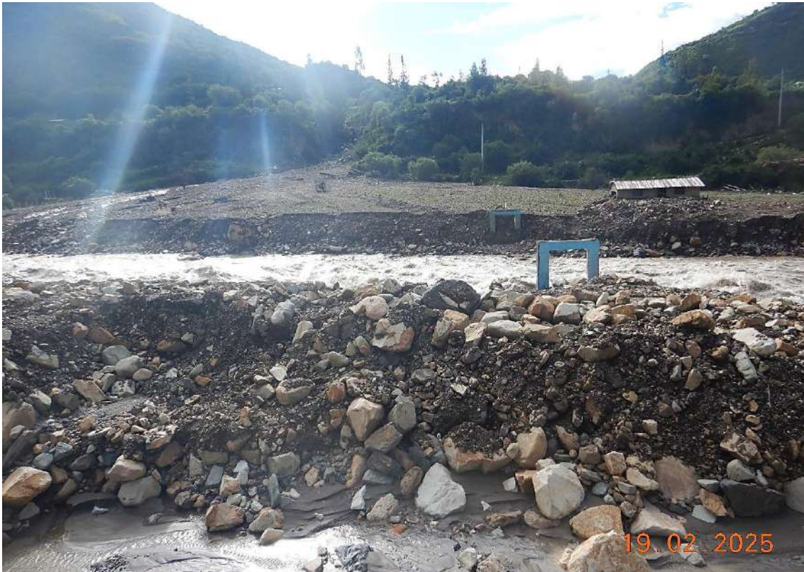
Fotografía 8: Depósitos tipo abanico, dejados por el flujo de detritos en febrero del 2024. Además, en la fotografía se puede observar el segundo piso de una vivienda y los estribos del puente destruido.
