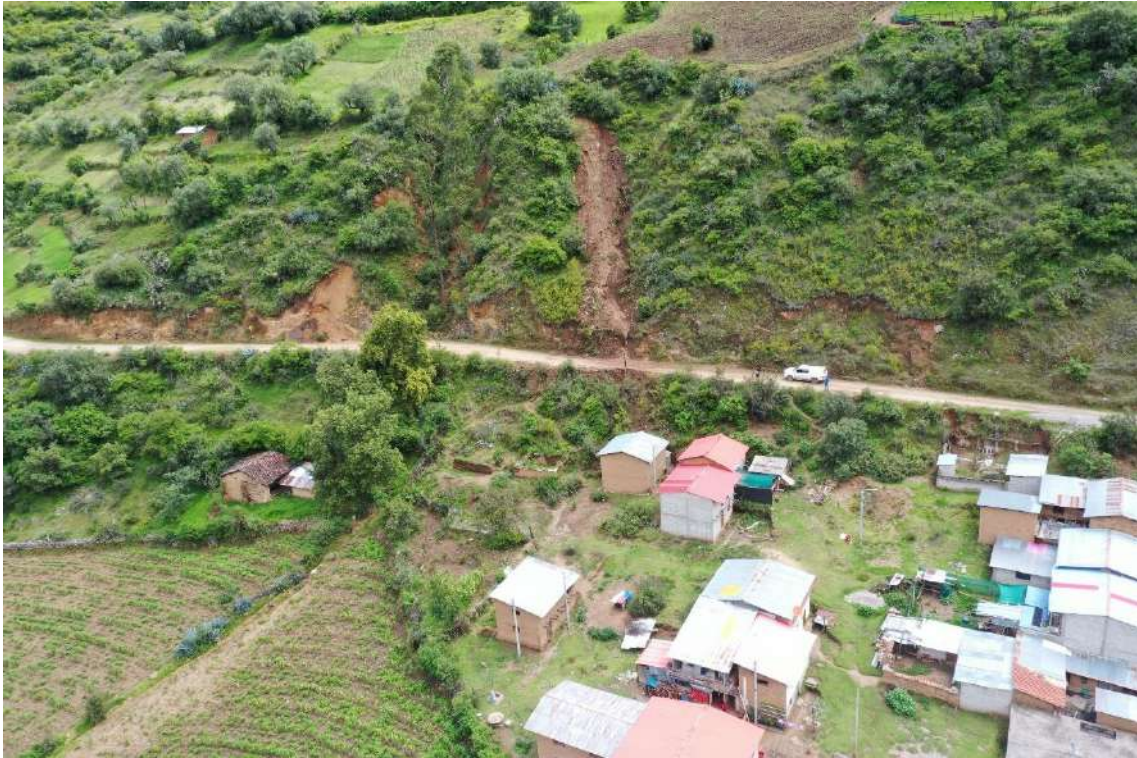
Fotografía 47: Deslizamientos de tipo rotacional detonados por lluvias y el riego por inundación en la parte alta de las coronas, presentan escarpas de 20 a 28 m de longitud con saltos de hasta 0.8 m y con distancias entre la escarpa y el pie de deslizamiento de 25 a 31 m
