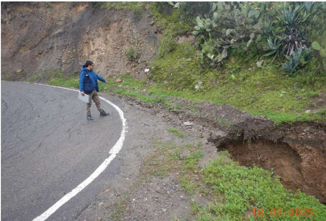
Fotografía 5: Proceso de erosión de ladera de tipo cárcavas que podría afectar la vía departamental. Además, se observa la carencia de un sistema de drenaje adecuado para la carretera, el cual estaría coadyuvando la erosión.
