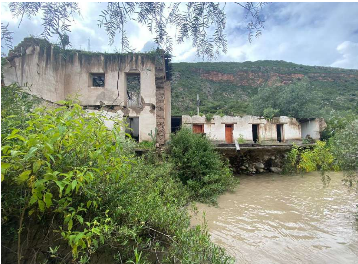
Fotografía 30: Socavamiento en la base de las viviendas, ubicadas en la margen derecha del río Chaluancal.
