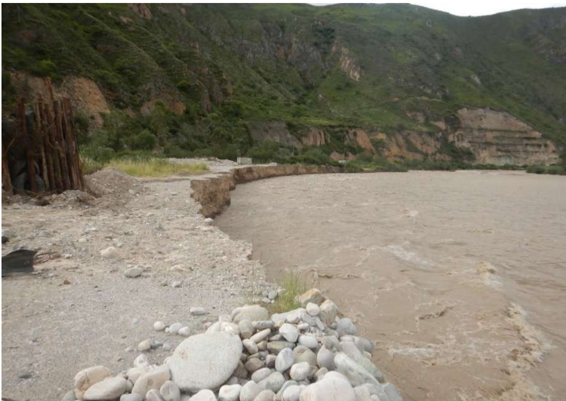
Fotografía 40: La erosión fluvial en la margen izquierda del río Chalhuanca, en este punto destruyó 220 m de la trocha carrozable.
