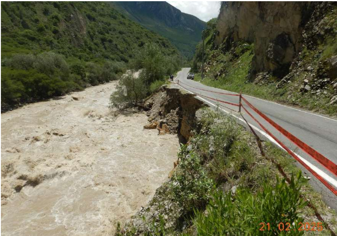
Fotografía 26: Afectación de la de la vía departamental Santa Rosa - Antabamba en aproximadamente 70 m lineales, por procesos de erosión fluvial debido al aumento del caudal del río Antabamba. Referencia Prog. 13+160.
