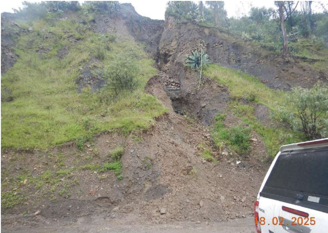
Fotografía 4: Proceso carcavamiento desarrollado en el cuerpo de un deslizamiento antiguo, el cual generó la afectación de la vía departamental PE-30A, en un tramo aproximado de 20 m lineales.
