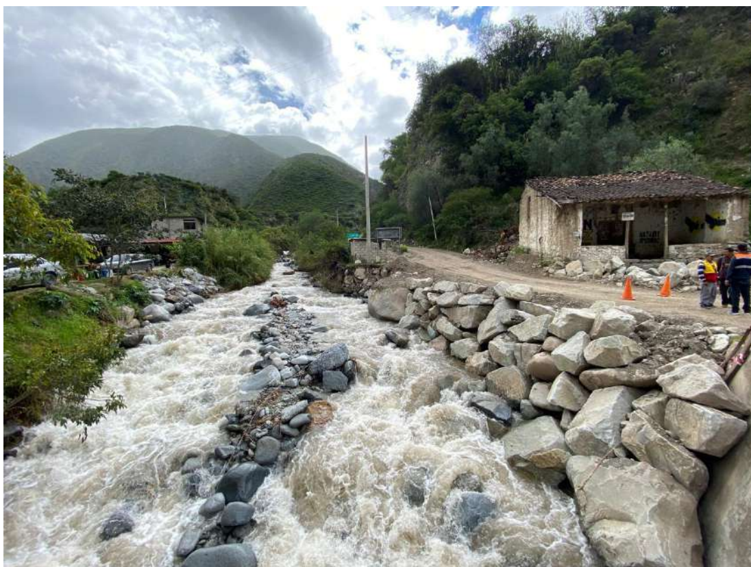
Fotografía 32: Erosión fluvial en la margen izquierda del río Huanchupampa, afectó 18.5 m de la trocha hacia San Francisco; actualmente están realizando trabajo de enrocado.
