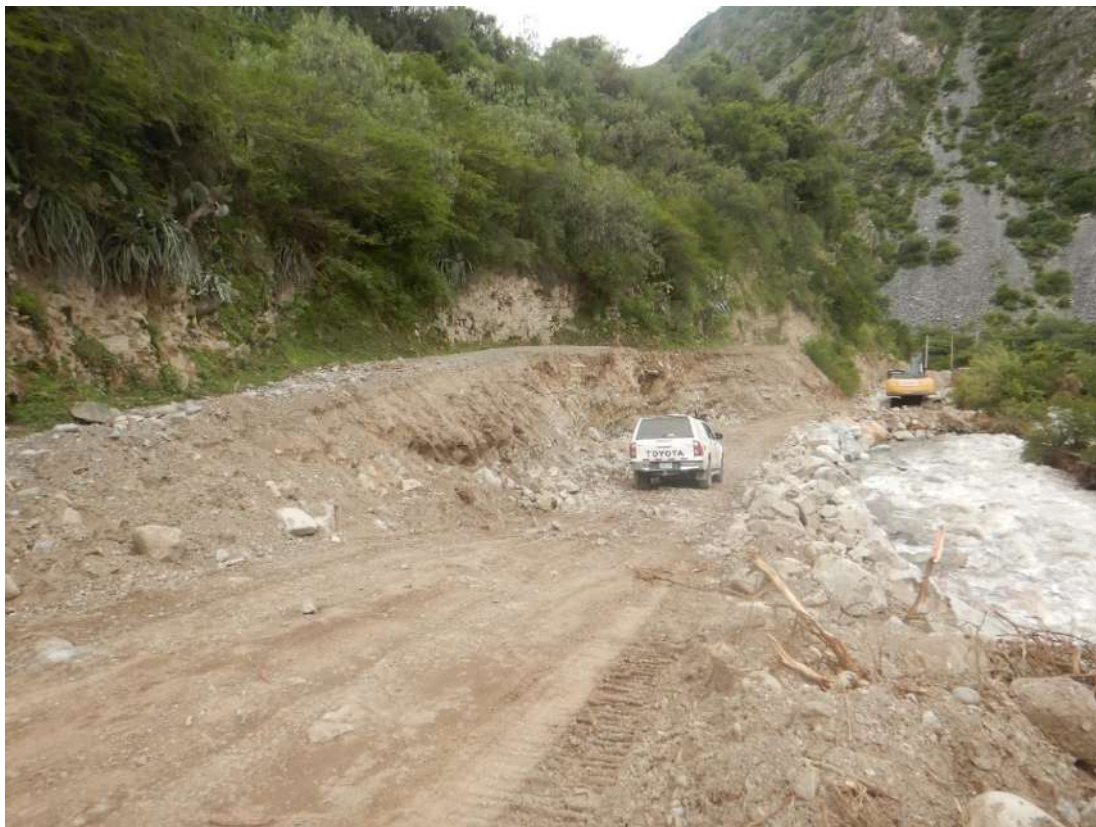
Fotografía 31: Erosión fluvial en la margen izquierda del río Huanchupampa, afectó 48 m de la vía San Francisco – Aporay, actualmente están realizando trabajos de enrocado.
