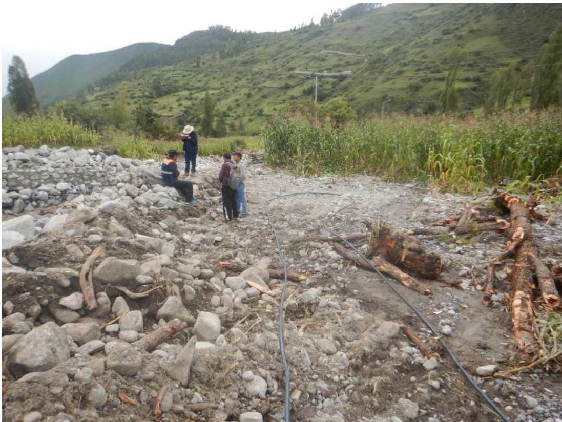
Fotografía 34: Flujo de detritos, producto de las lluvias prolongadas ocurridas el 11 de febrero, destruyo el enrocado de la margen derecha, el mismo que se había instalado recientemente.
