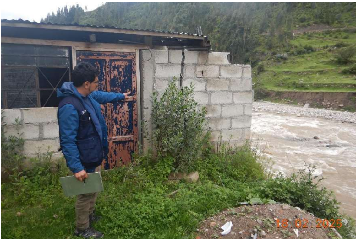
Fotografía 3: Afectación de 01 vivienda a consecuencia de la erosión fluvial, por socavamiento al pie de la terraza aluvial, registrado en enero del 2024.
