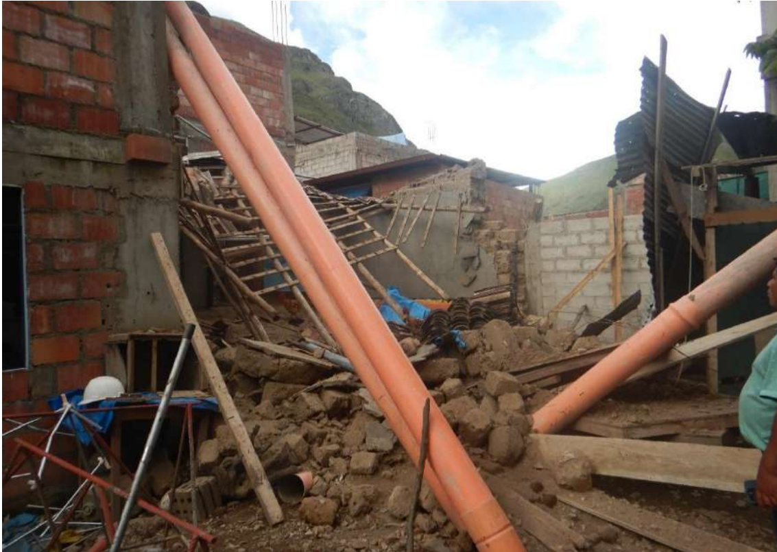
Fotografía 41: Vivienda de adobe colapsada. producto de las reactivaciones ocurridas el 15 de enero, 5 febrero y 11 de febrero del 2025; así mismo se evidenció humedad en las viviendas contiguas de material noble.
