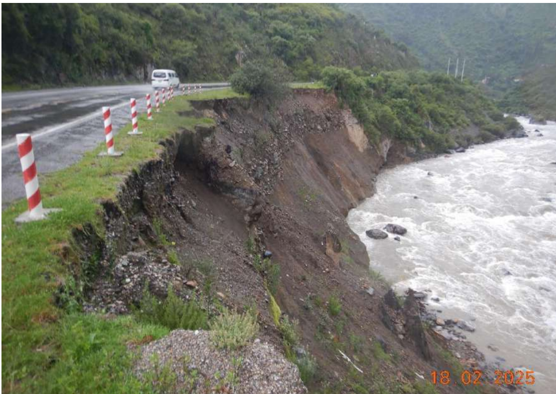
Fotografía 7: Vista del tramo vial nacional PE-30A (Chalhuanca), el cual podría ser afectado por erosión fluvial por socavamiento al pie de la carretera.
