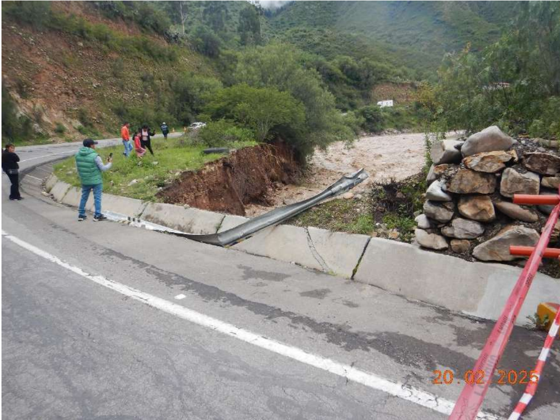
Fotografía 15: Erosión fluvial por socavamiento al pie de la carretera, que podría comprometer la seguridad física de la cuneta y la vía nacional en un tramo de 15 m. Referencia: Puente Cuycua (Sañayca).
